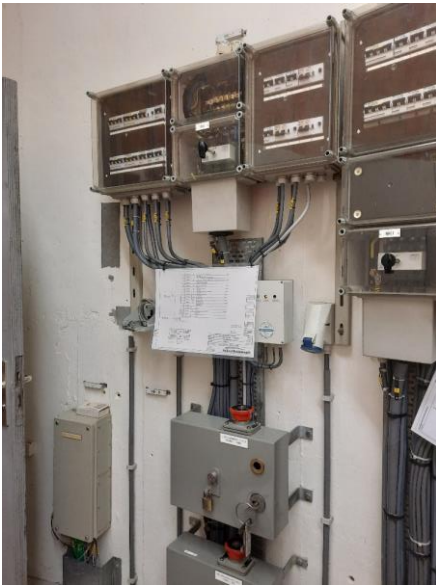
Figuur 32: energie technisch ruimte ProRail bediengebouw
