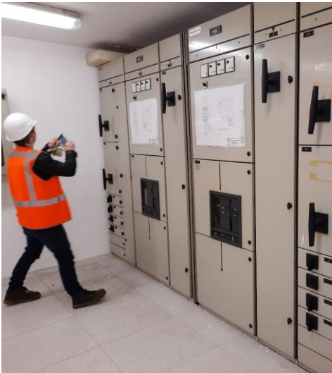
Figuur 10: Energieschakelaars hefbrug
