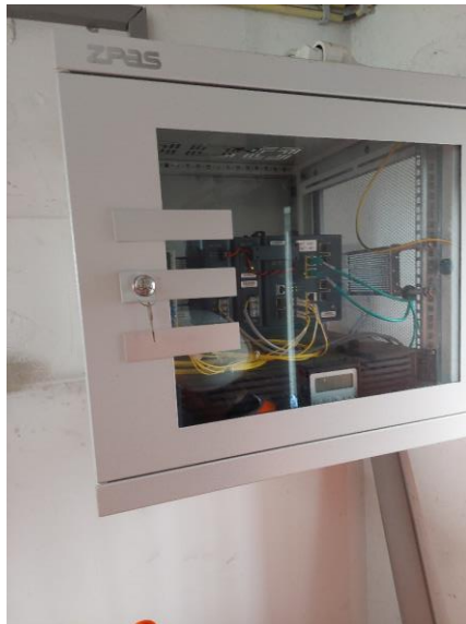
Figuur 45: Telecomkast camera oude bediengebouw
