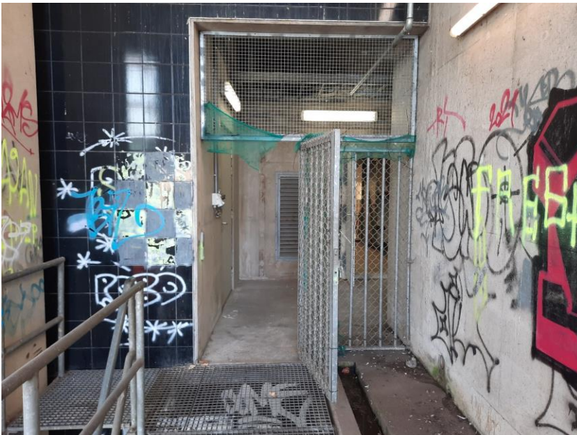
Figuur 48: Ingang technische ruimtes ProRail (energie, (aan)sturing brug en aggregaat)
