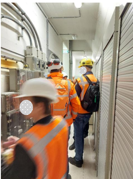
Figuur 38: Technische ruimte basculebrug dordrechtzijde (RWS)
