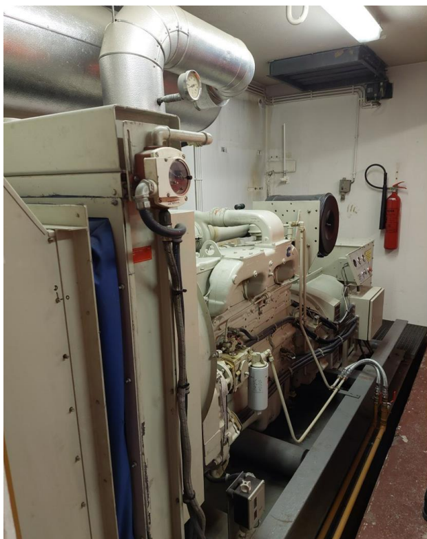
Figuur 4: diesel aggregaat ruimte ProRail hefbrug
