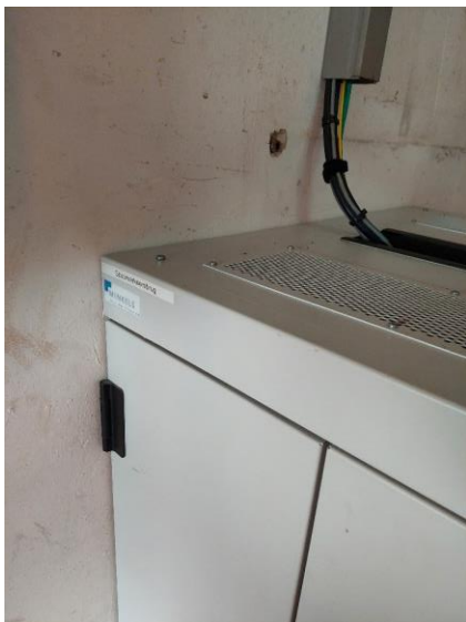
Figuur 43: bedienkast RWS brug in oude bediengebouw RWS
