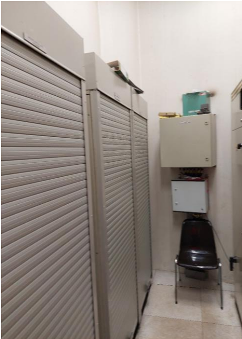
Figuur 35: besturingskasten RWS brug in technische ruimte RWS bediengebouw
