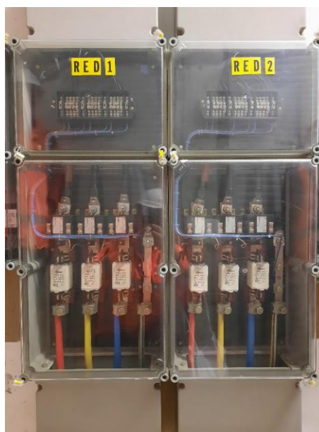
Figuur 40: energieaansluiting basculebrug RWS dordrechtzijde
