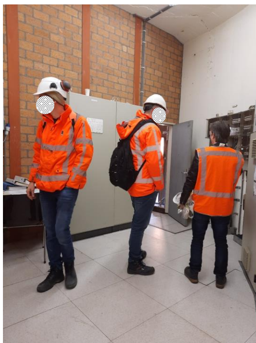
Figuur 27: overzicht technische ruimte ProRail Bediengebouw
