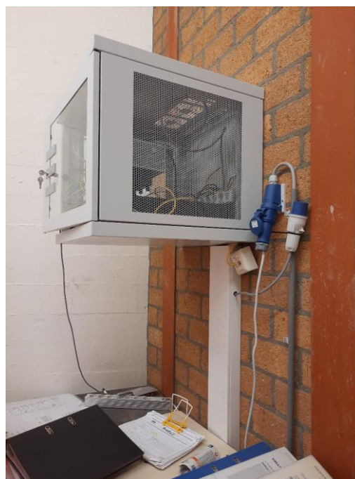
Figuur 31: Telecomkast tbv brug RWS (camera?) in technische ruimte ProRail bediengebouw
