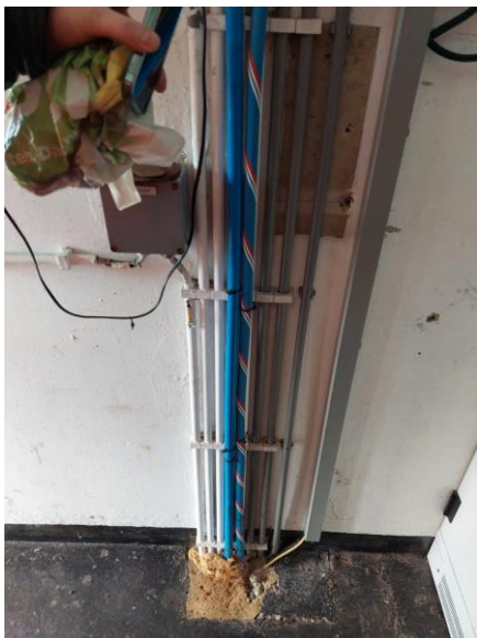
Figuur 44: telecomkabels oude bediengebouw RWS
