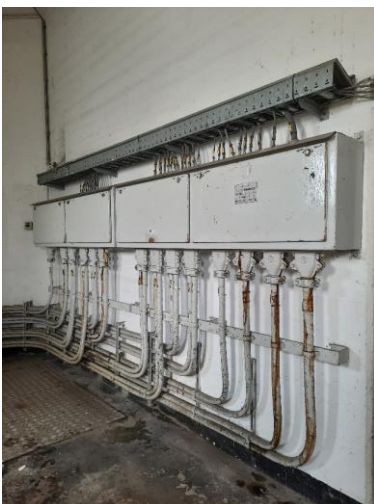
Figuur 57: waterkabels RWS
