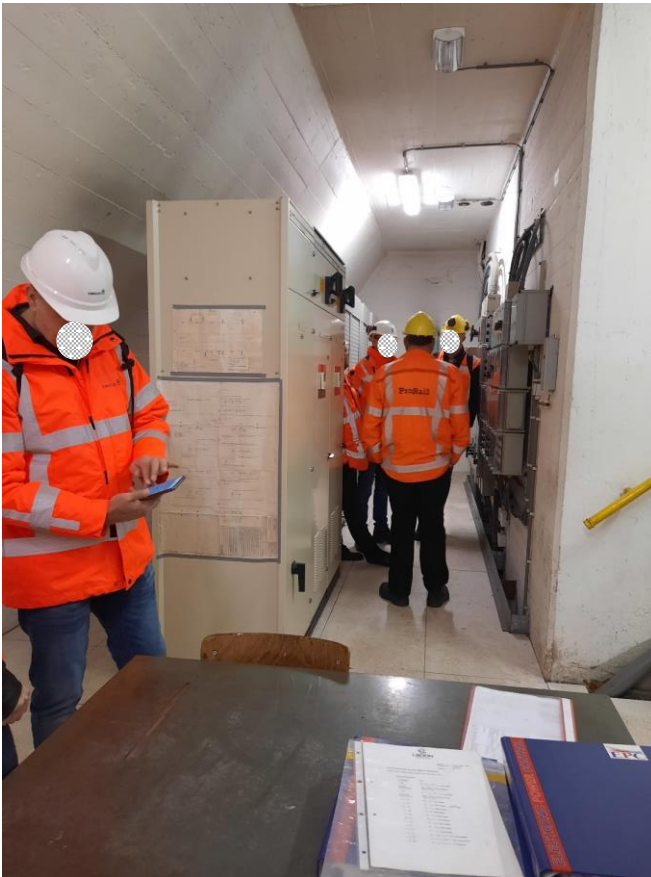
Figuur 41: Technische ruimte basculebrug dordrechtzijde (RWS) (2)
