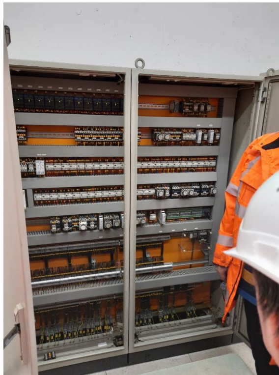
Figuur 14: Kast storing pc master in ruimte ProRail hefbrug
