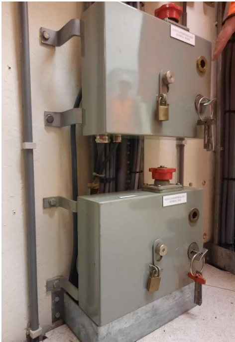
Figuur 28: Sleutelverdeelkast handbediening hefbrug (vegrendeling) technische ruimte ProRail bediengebouw
