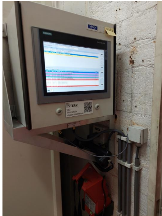
Figuur 36: storing PC (slave) in technische ruimte RWS bediengebouw
