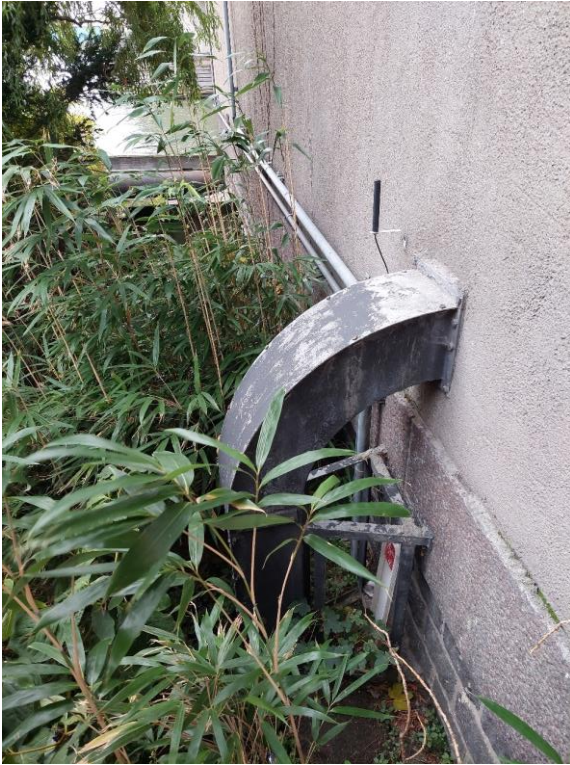
Figuur 47: uitgang kabels dordrechtzijde basculebrug RWS
