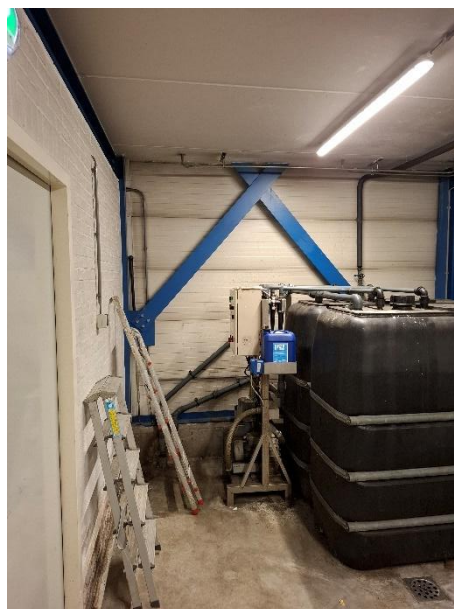
Figuur 10: Te verwijderen waterrecycling en pompset
