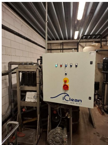
Figuur 6: Te verwijderen waterrecycling, breektank en pompset
