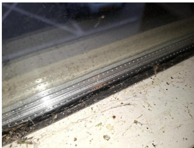
Om het glas van de voordeuren bevindt zich zwart schuimband
