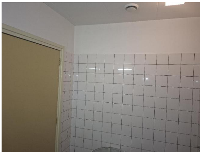
Toilet heren, tegels op de vloer en wand in specie
