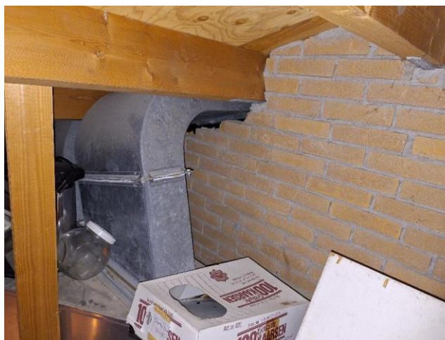
Tussen de flenzen van ventilaiekanalen zit niet asbestverdachte transparante kit.
