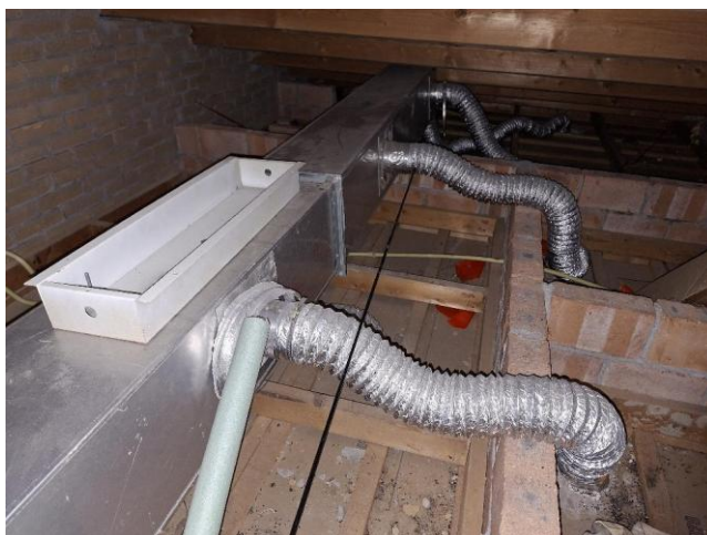
Ventilaiekanalen van flexibel aluminium buizen
