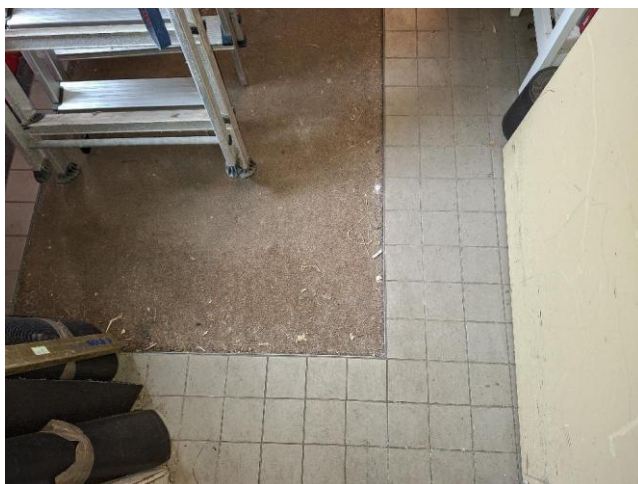
In de tussenhall zijn tegels in specie aanwezig
