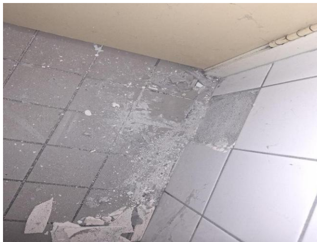
Tegelwerk in het toilet zit in specie aan de wand en vloer
