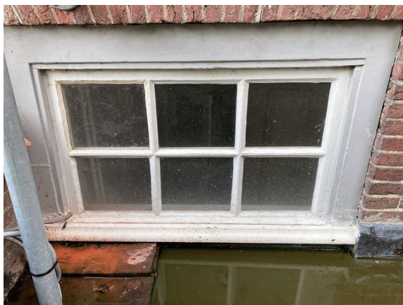
gevel no. 4: weldorpel niet afgelakt (2024)
