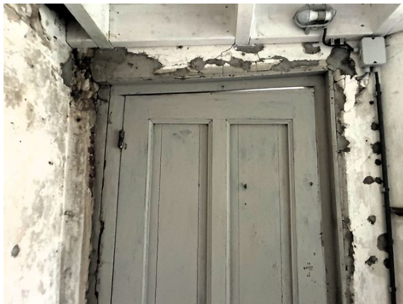
berging: binnenpleisterwerk beschadigd (2025)
