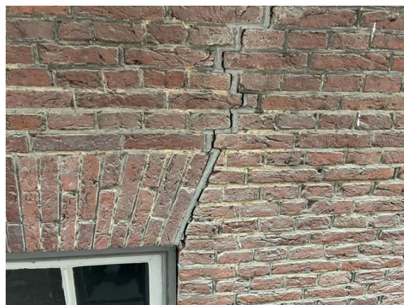
gevel no. 3: scheurvorming (2025)
