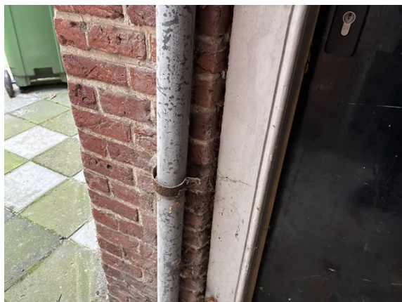
gevel no. 5: afvoerbeugel los (2025)
