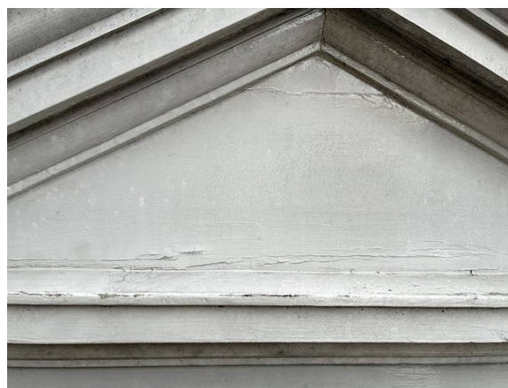
dakkapel no. 5: verf gebarsten (2025)
