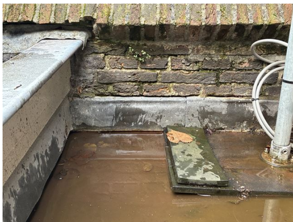
dak no. 10: voegwerk ontbreekt (2025)
