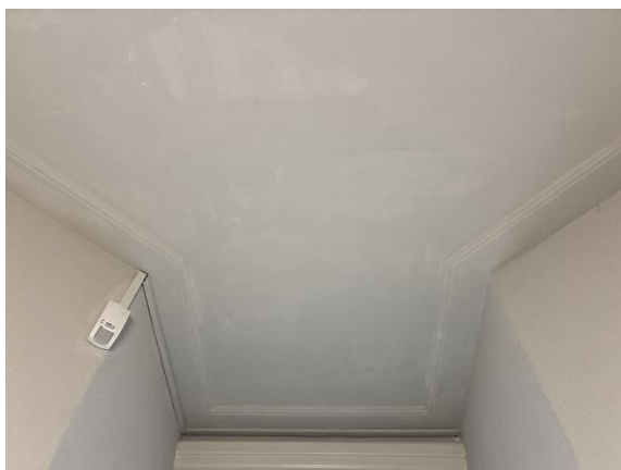
hal: plafond niet geheel dekkend uitgevoerd (2025)
