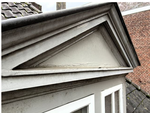
dakkapel no. 8: verf gebarsten (2025)
