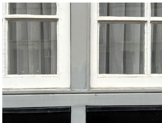
gevel no. 2: stopverf losgescheurd (2025)
