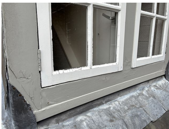
dakkapel no. 8: verf gebarsten (2025)
