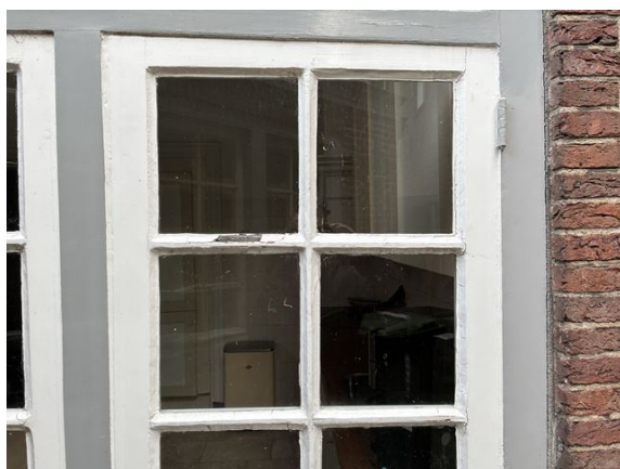
gevel no. 4: stopverf plaatselijk gescheurd (2025)
