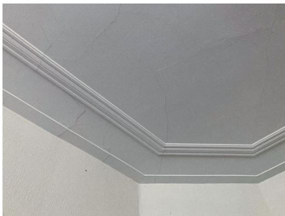
begane grond: verf van plafond bij scheurvorming beschadigd (2024)
