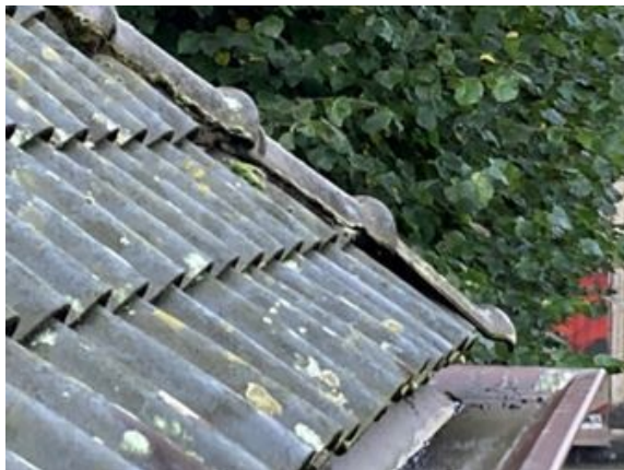
dak no. 1-4: speciezoom onder hoekkepervorst ontbreekt (2023)
