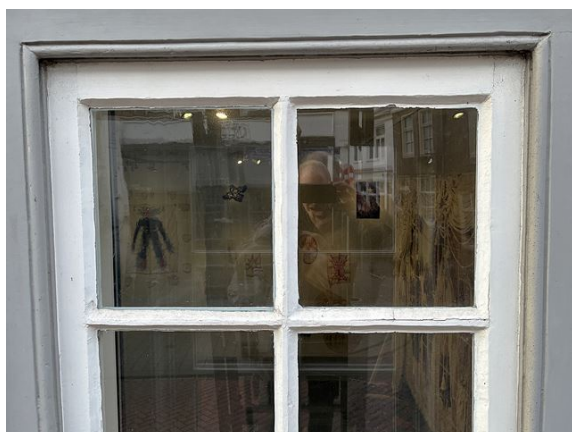
gevel no. 4: stopverf gebarsten (2025)
