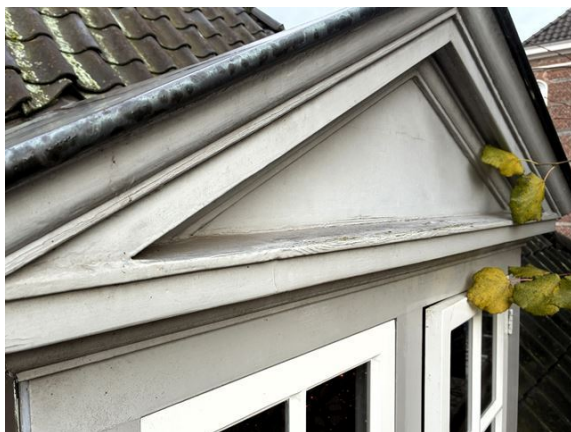
dakkapel no. 5: buitenschilderwerk gebarsten (2025)
