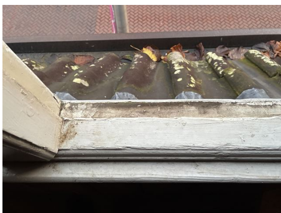
dakkapel no. 7: buitenraam niet geopend tijdens het uitvoeren van het buitenschilderwerk (2025)
