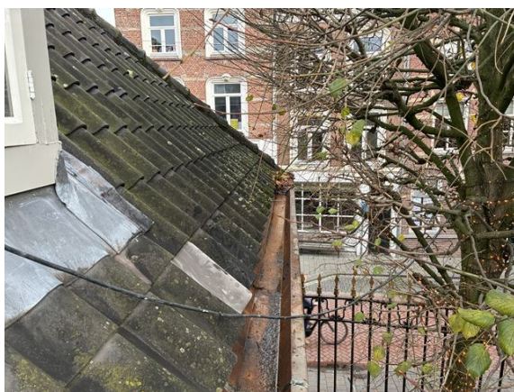
buitenruimte no. 1: takken raken dak en goot (2025)
