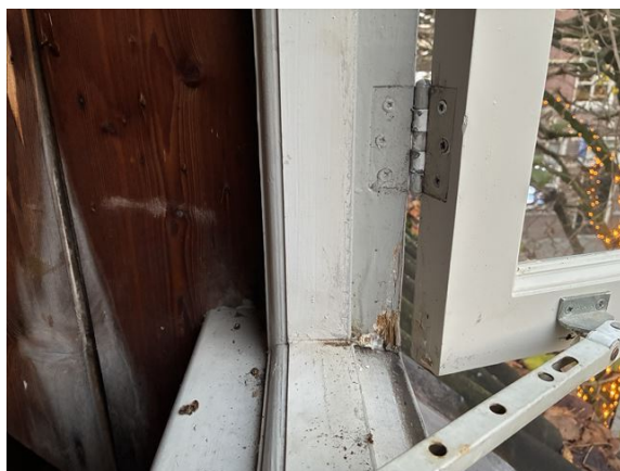
dakkapel no. 5: houtwerk buitenraamkozijn ingerot (2025)
