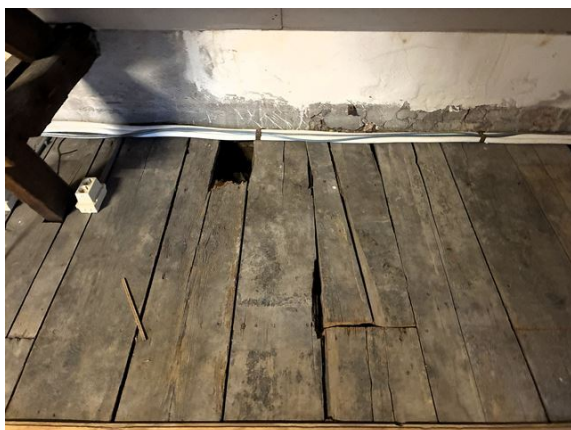
zolder: vloerdeel beschadigd (2025)
