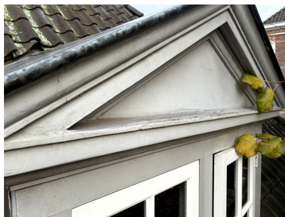
dakkapel no. 5: takken raken het houtwerk (2025)
