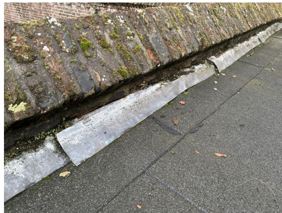
dak no. 8: gevellood losgekomen (2025)
