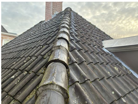
dak no. 2-3: speciezomen bovenop hoekkepervorsten losgekomen en weggevallen (2025)
