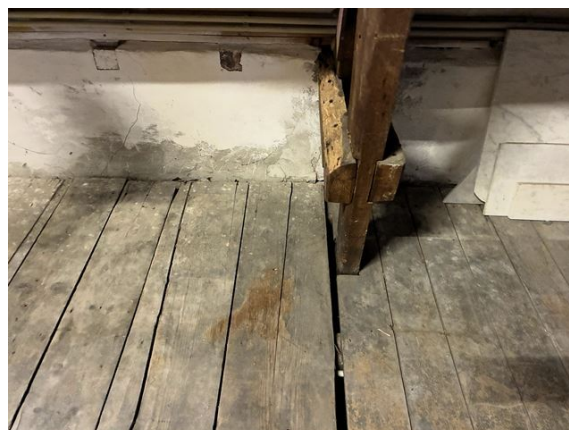
zolder: vloerdelen gescheurd (2025)
