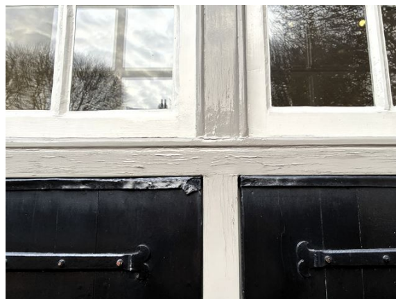
gevel no. 1: verf gebarsten (2025)
