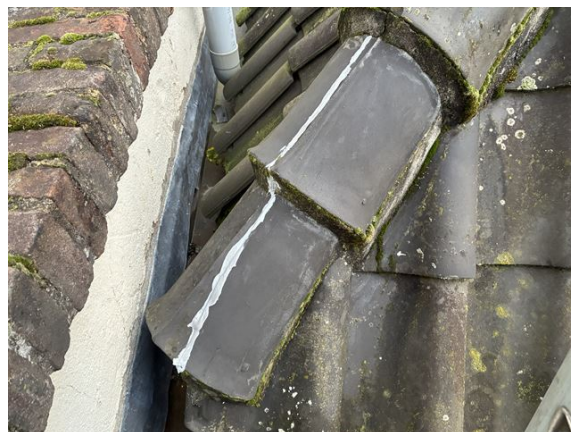
dak no. 2-3: gescheurde hoekkepervorsten tijdelijk met kit afgedicht (2025)
