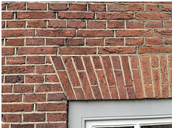
gevel no. 1: scheurvorming boven buitenramen (2025)
