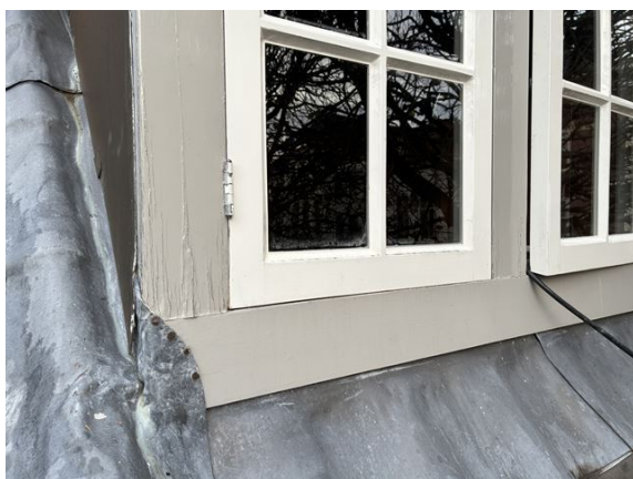
dakkapel no. 5: verf gebarsten (2025)
