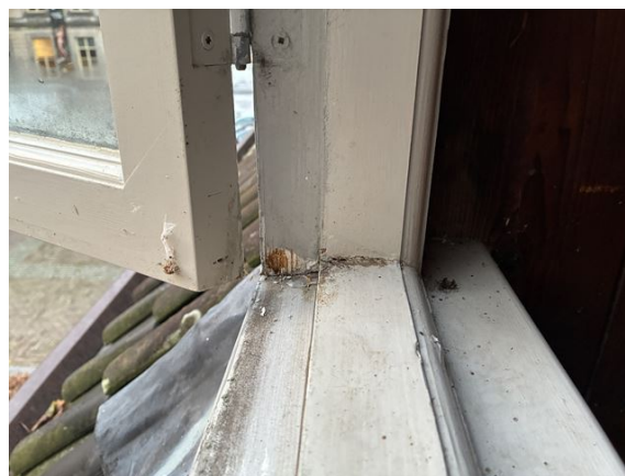
dakkapel no. 5: houtwerk buitenraamkozijn ingerot (2025)
