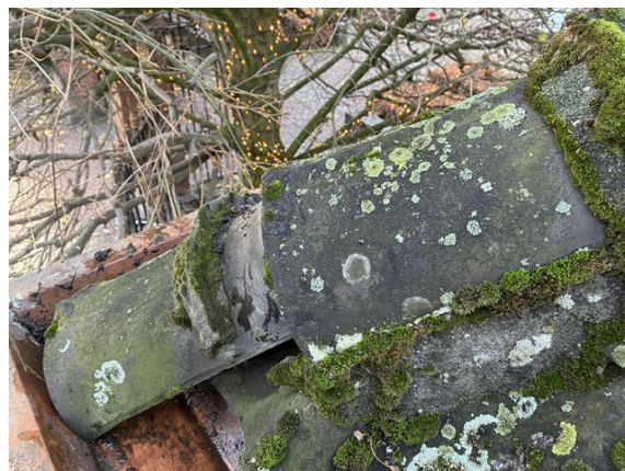
dak no. 1-4: hoekkepervorst afgeschoven (2025)
