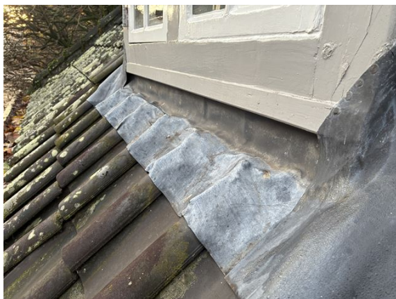
dakkapel no. 7: lood flink geplooid doordat de onderliggende dakpannen niet afgeschuind zijn (2025)
