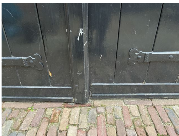
gevel no. 2: buitendeuren zijn aangetast door zwam (2025)
