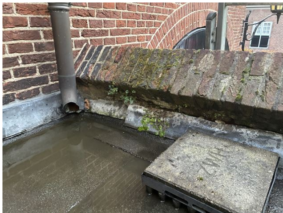
dak no. 8: gevellood losgekomen (2025)
