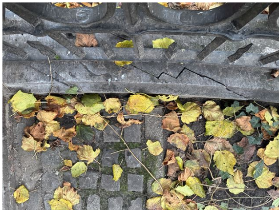
gevel no. 9: hardsteen element gescheurd (2025)
