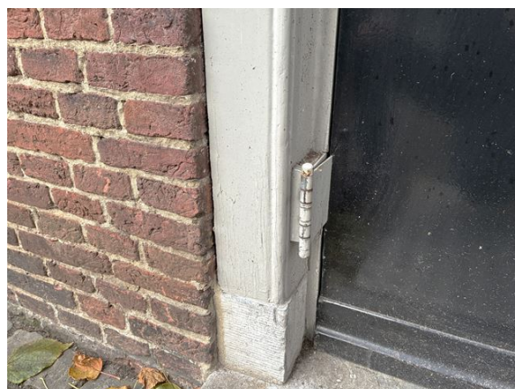
gevel no. 1: verf gebarsten (2025)
