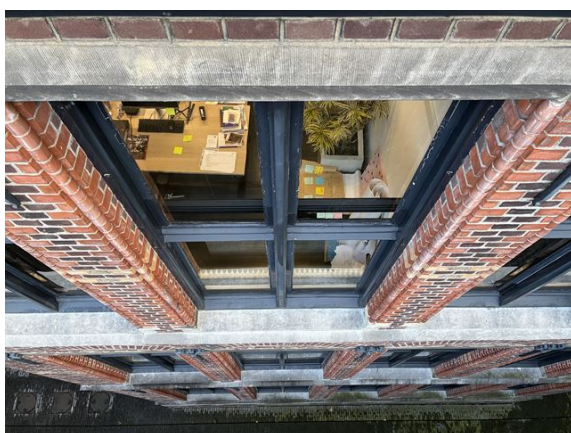
gevel no. 38: verf tweede verdieping vaal en gebarsten (2025)
