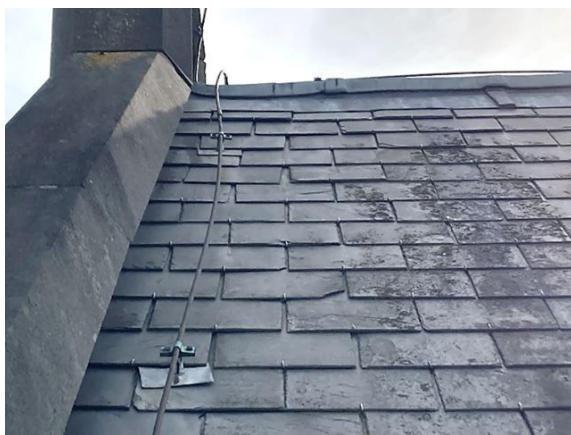
dak no. 1: leien verschoven, lei beschadigd (2023)
