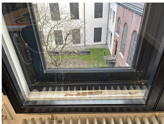
gevel no. 32: verf afgebladderd (2025)
