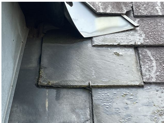
dak no. 1: loden loket ontbreekt (2024)
