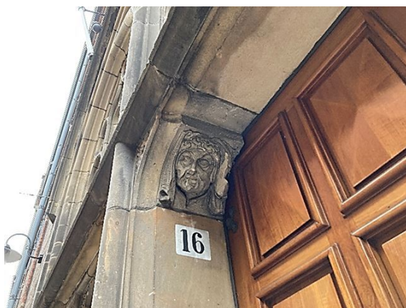
gevel no. 1: hoofd beschadigd (2023)
