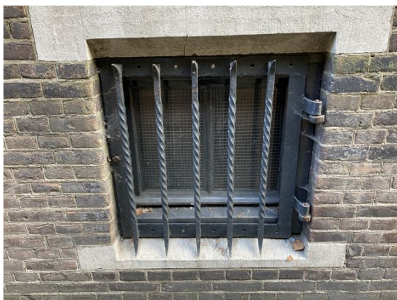
gevel no. 1: diefijzers roestig (2024)
