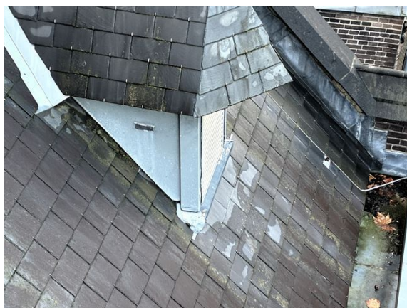
dakkapel no. 36: verf gebladderd (2025)
