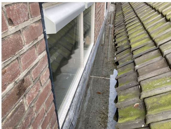
gevel no. 34: stopverf niet afgelakt, stopverf gebarsten (2024)
