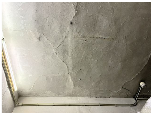
kelder: plafond cv-ruimte flink gescheurd (2025)
