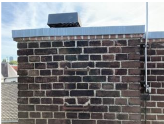
schoorsteen no. 1: klimbeugels roestig (2023)
