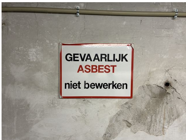
kelder: asbest aanwezig kelder en kruipruimtes (2025)
