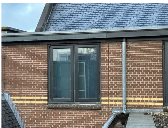
gevel no. 3: buitenschilderwerk plaatselijk niet uitgevoerd (2025)
