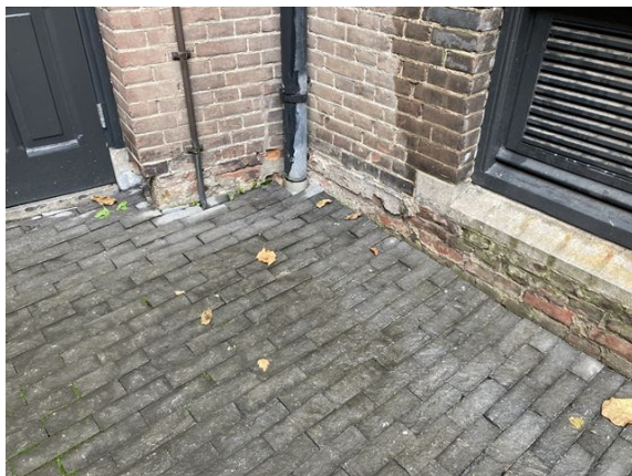
gevel no. 3: metselwerk naast buitendeur beschadigd (2024)
