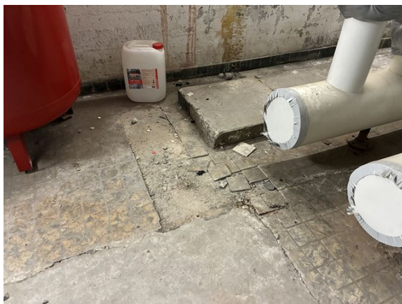
kelder: vloertegels cv-ruimte losgekomen (2025)
