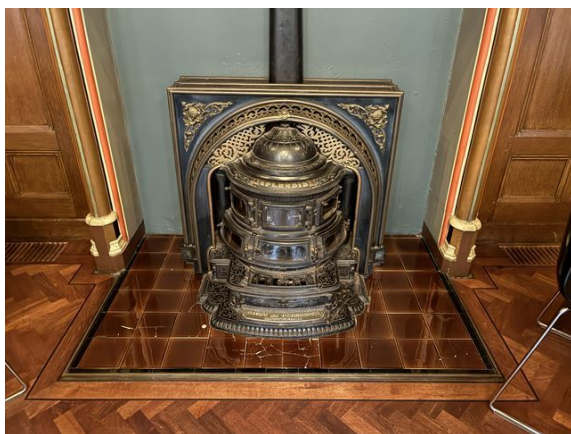
begane grond: beschadigde vloertegels (2025)
