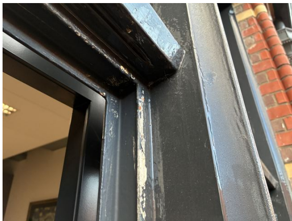
algemeen: verf beschadigd, omdat buitenramen te snel zijn gesloten na het uitvoeren van het buitenschilderwerk (2025)
