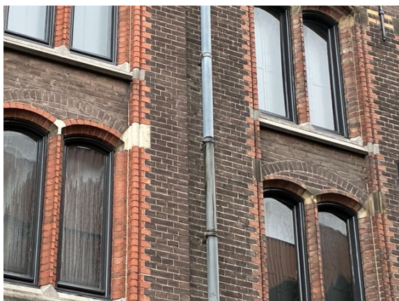
gevel no. 23: regenwaterafvoer poreus en lek (2025)
