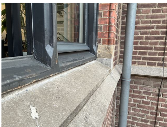
gevel no. 40: verf gebarsten en gebladderd tweede verdieping (2025)
