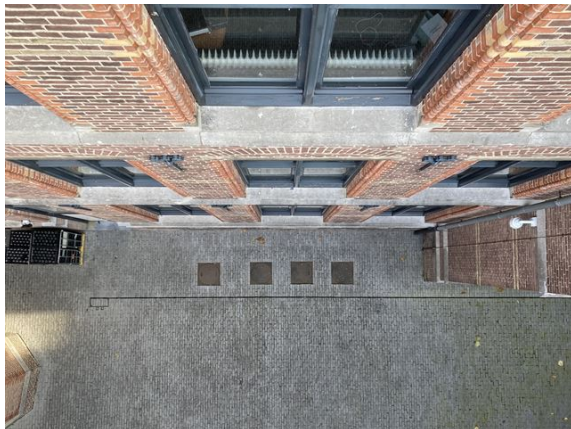
gevel no. 40: hout van onderdorpel verweerd (2024)
