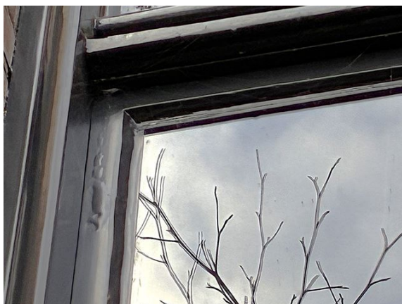
gevel no. 3: blaas in verf (2025)
