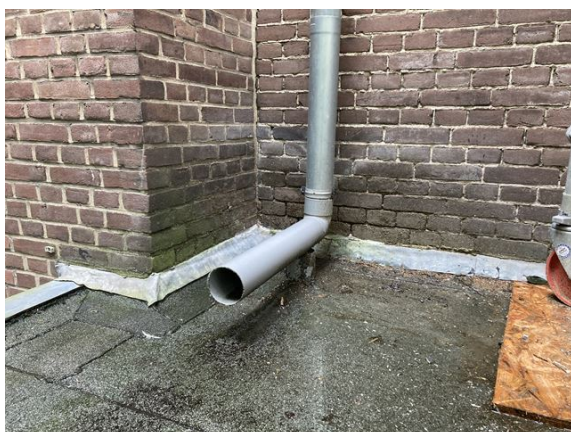
gevel no. 3: voegwerk boven gevellood dak no. 17 plaatselijk weggevallen (2024)
