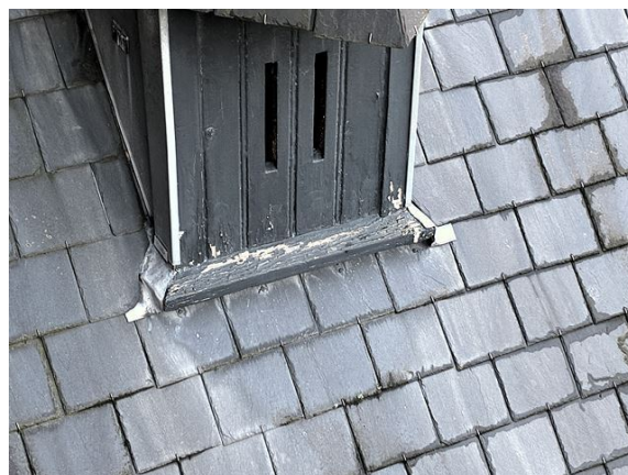
dakkapel no. 35: verf gebladderd (2025)
