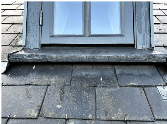
dakkapel no. 28: onderdorpel onvoldoende voorberekt voor uitvoering buitenschilderwerk (2025)
