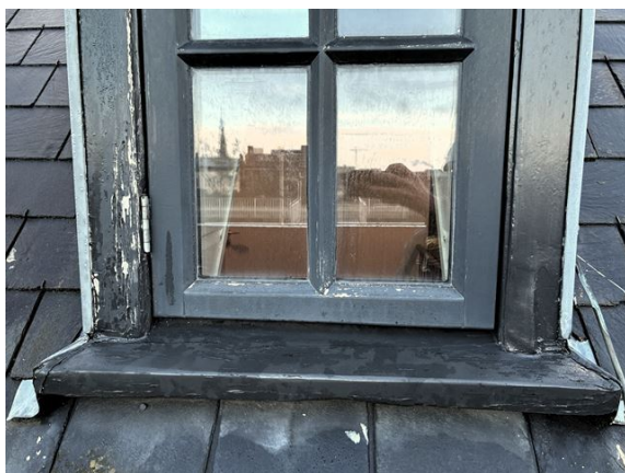
dakkapel no. 26: verf afgebladderd (2025)
