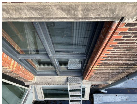
gevel no. 36: verf gebarsten en vervaald (2025)
