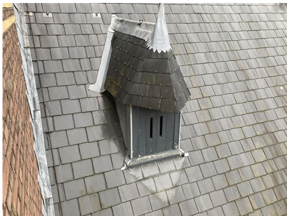
dakkapel no. 35: onderdorpel verweerd en ingerot (2024)
