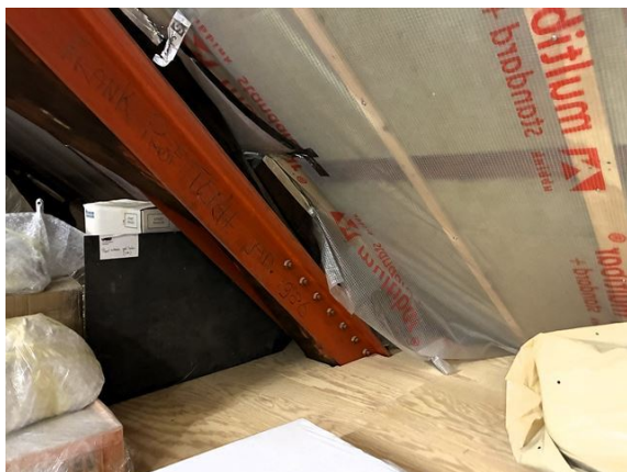
zolder Statenzaal: losgekomen folie (2025)
