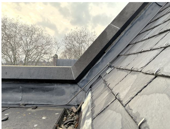
gevel no. 4: gevellood gescheurd, voegwerk weggevallen (2025)
