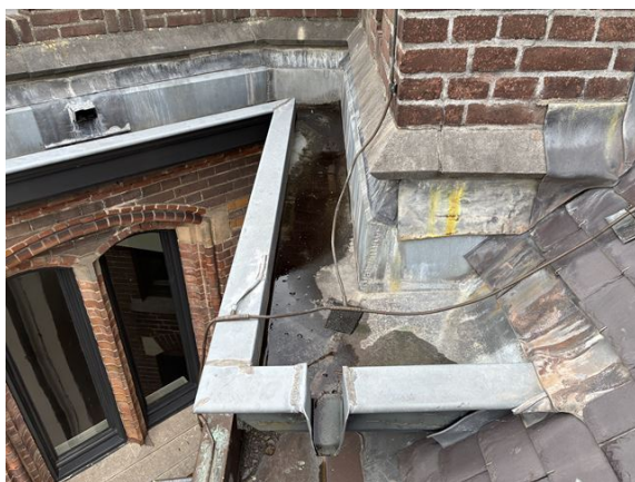
goot no. 15: beschadigd zink met bitumen bedekking afgedicht (2025)
