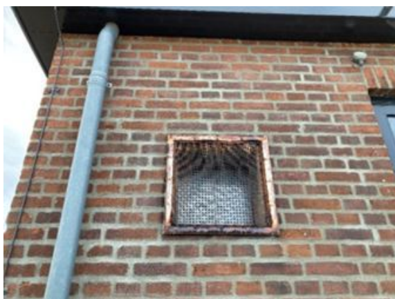
gevel no. 11: ventilatierooster roestig (2023)
