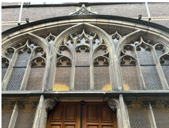
gevel no. 1: natuurstenen latei boven voordeur verzakt (2025)
