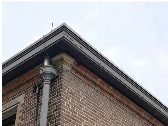
gevel no. 35: verf boeiboord gebladderd (2025)
