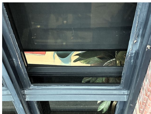
gevel no. 40: verf gebarsten en vervaald (2025)
