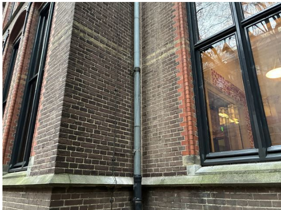
gevel no. 37: lekkage door te geringe overlapping bij verbinding (2025)
