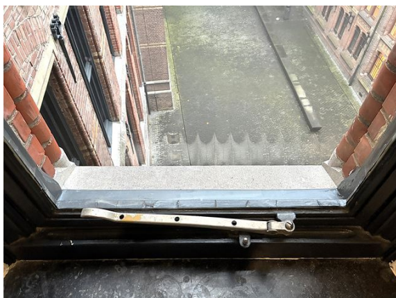
gevel no. 3: stopverf gebarsten (2025)
