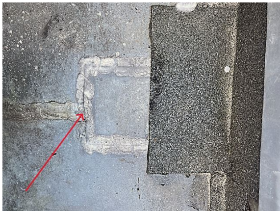
goot no. 5: opnieuw gescheurde soldeernaad, tijdens inspectie 2023 tijdelijk met kit afgedicht (2023)
