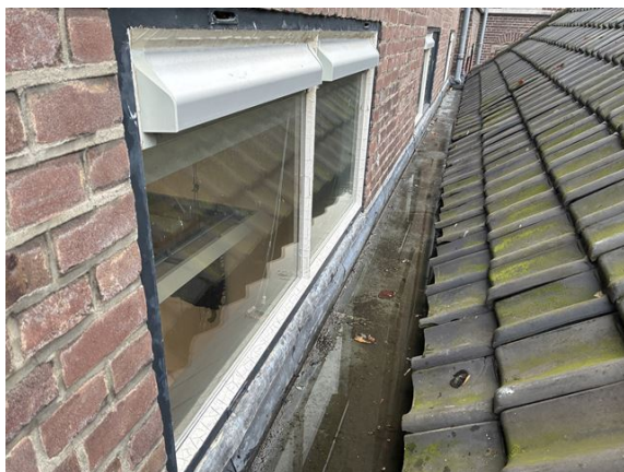
gevel no. 34: stopverf eerder vernieuwd en gebarsten (2025)
