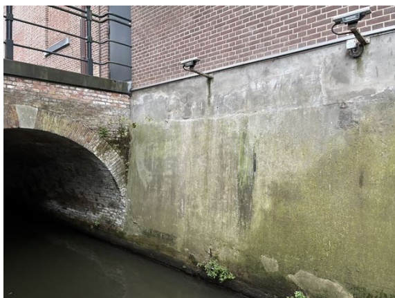
gevel no. 24: buitenpleisterwerk beschadigd (2025)
