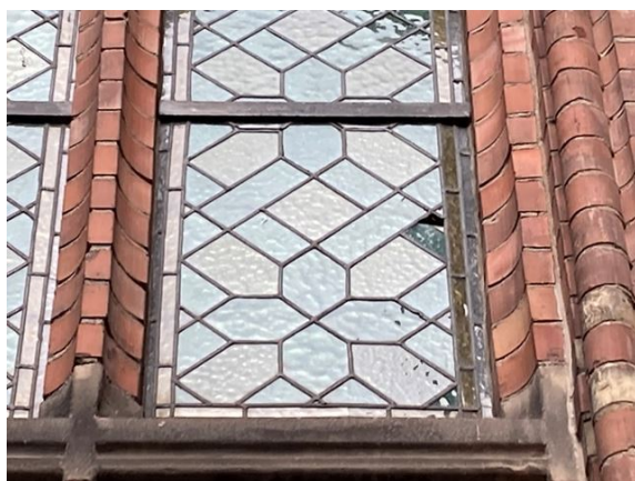
gevel no. 3: glas in lood beschadigd boven westelijke achterdeur (2023)
