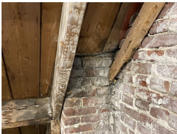
technische ruimte: kapconstructie dak no. 12 plaatselijk ingerot (2024)
