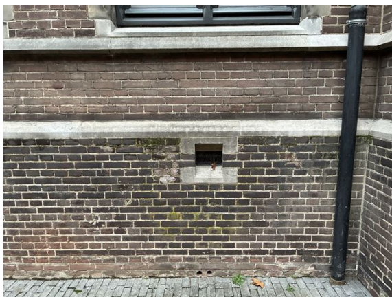
gevel no. 40: afgeschilferde bakstenen (2025)
