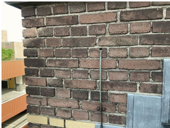
gevel no. 2: verweerd voegwerk aanzet topgevel (2023)
