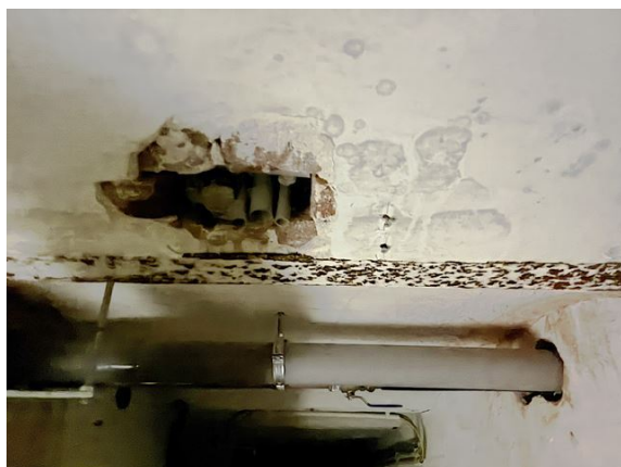
kelder traptoren: stalen balken roestig, metselwerk bij doorvoer beschadigd (2025)
