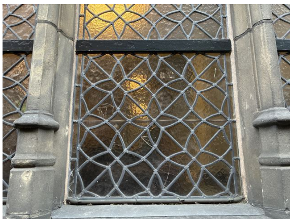
gevel no. 1: glas in lood bij voordeur beschadigd (2025)
