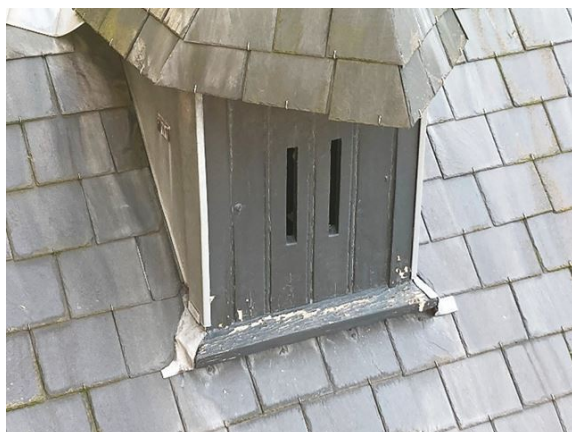
dakkapel no. 35: lood ontbreekt onder kozijndorpel (2023)
