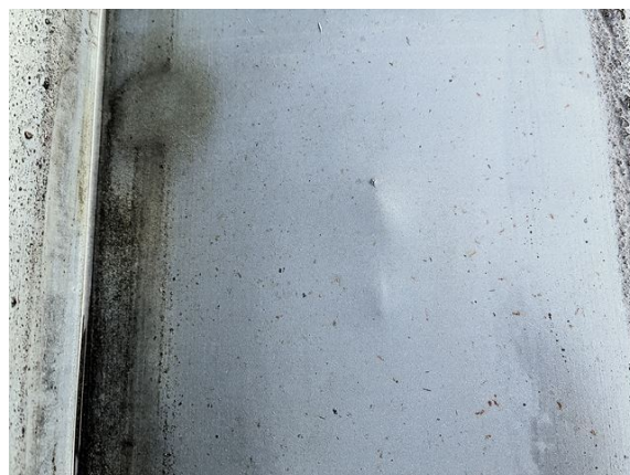
goot no. 1: zinkbekleding beschadigd door onderliggende gootbeugels (in 2025 tijdelijk met kit afgedicht) (2025)
