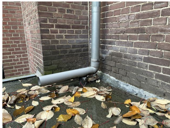
dak no. 17: voegwerk uitgespoeld (2025)
