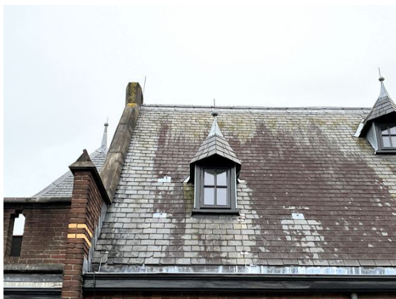
dak no. 1: leien beschadigd (2025)
