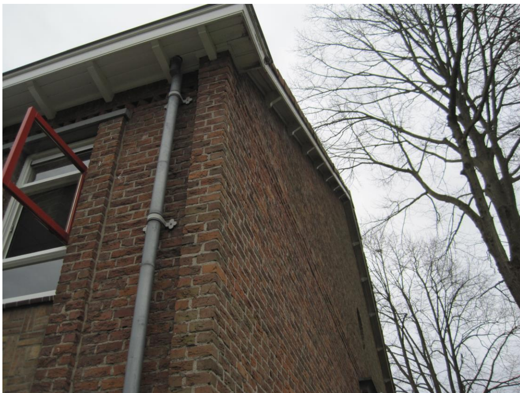
Figuur 3.1 Overhangende dakpannen bij gebouw K46. Bron: Ecogroen.
