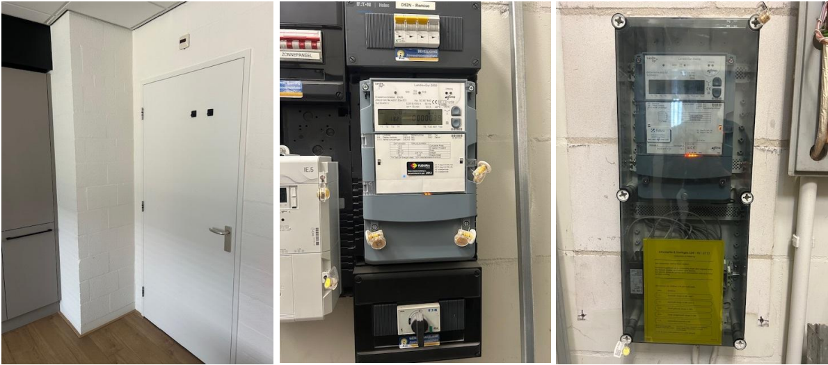
Kazerne Deventer (is al aangesloten op een noodstroomaggregaat)
