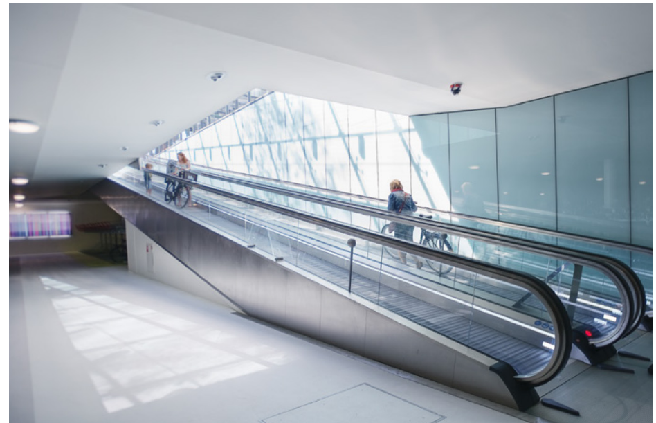
Illustratie: wit glazen wanden naast de Tapis Roulants reflecteren het daglicht (Mahlerpleinstalling Amsterdam – ontwerp studioSK)
