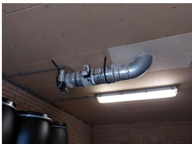
Ventilatie en luchtbehandeling
