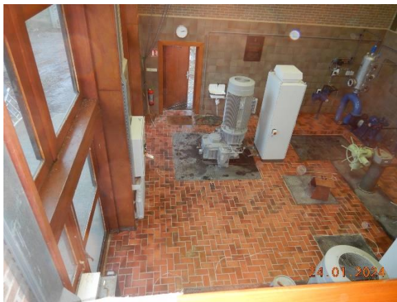
Figuur 6: Binnenzijde pomphuis, aanzicht pompen.
