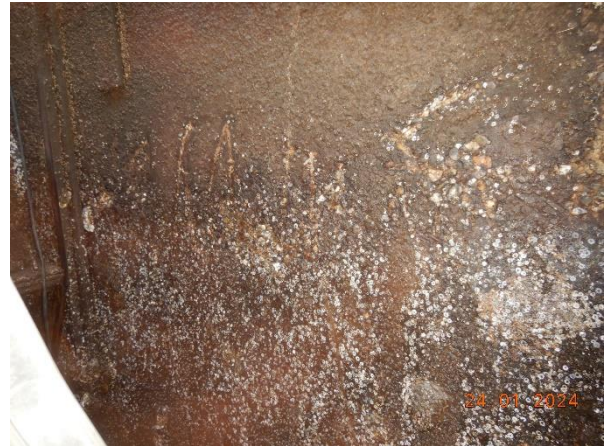
Figuur 28: Uitgewassen betonoppervlak uitstroom.
