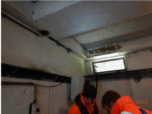
Figuur 23: Dekkingsschade beton rondom luiken.
