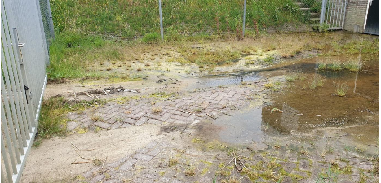
Figuur 10: Lekkage noordzijde van het pompgebouw 2019.
