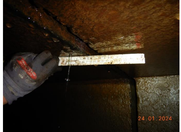
Figuur 32: Lekkende dilatatievoeg.
