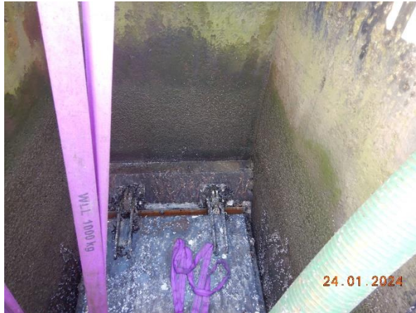
Figuur 27: Vervuiling betonconstructie uitstroom.
