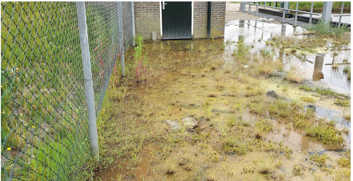
Figuur 11: Lekkage noordzijde van het pompgebouw 2022.
