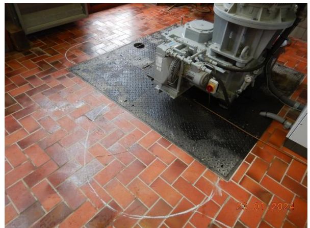
Figuur 20: Holklinkende delen tegelvloer.
