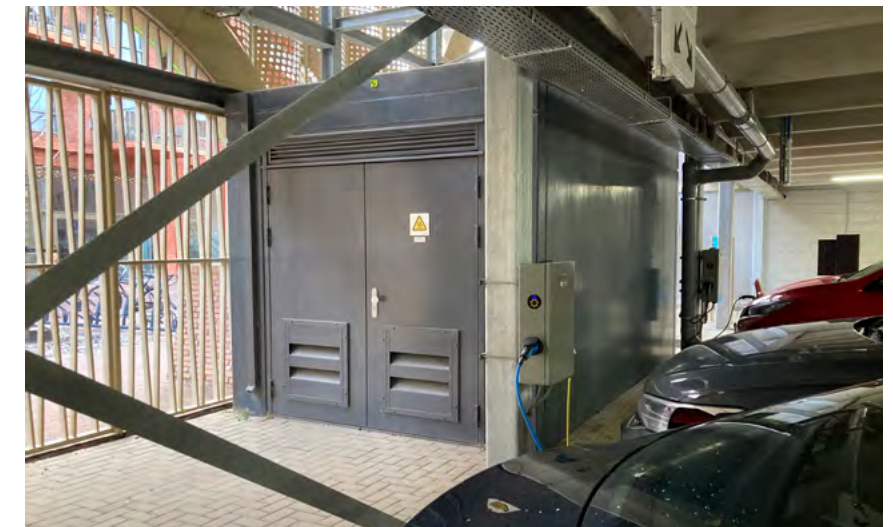
Trafo's worden in de gebouwen geplaatst en waar mogelijk ook in pandig ontsloten, bijvoorbeeld bij parkeergarages.
