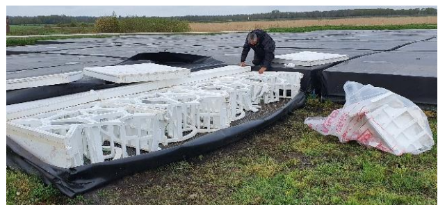
Beschadigde HBA boxen (door maaimachine/tractor)
