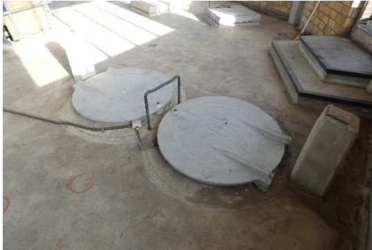
Afb. 84. De met deksels afgesloten mangaten voor het betreden van de waterreservoirs.
