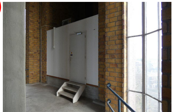
Afb. 32. De 'SDH transmission room' ten behoeve van het telecomverkeer.
