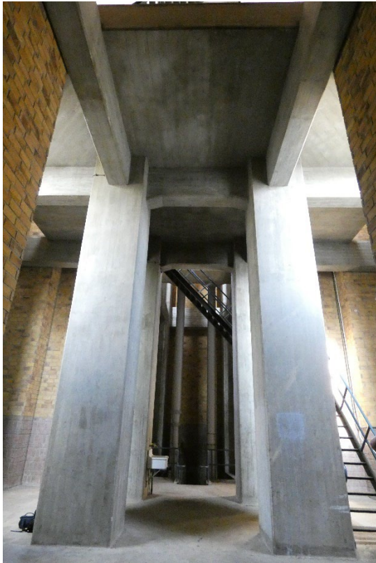
Afb. 60. In het centrum van de toren staan in een vierkant vier zwaar uitgevoerde betonkolommen.
