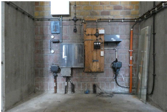
Afb. 65. De 'open' meterkast, links van de entree.
