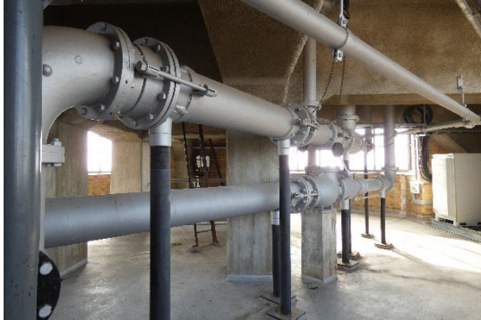
Afb. 67. Overzicht van de waterleidingsinstallatie op de lekzolder.
