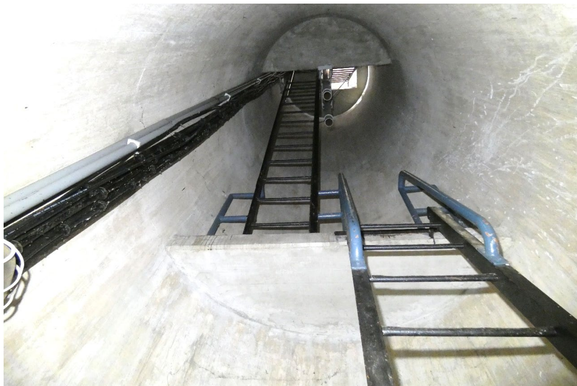
Afb. 76. De ladders in de koker waarmee men door het waterreservoir heen de lantaarn kan bereiken.
