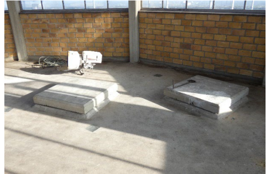
Afb. 85. De vierkante afsluitingen van de ontluftingskokers voor de aan- en afvoer van lucht bij daling en stijging van de waterspiegel in de watervaten.
