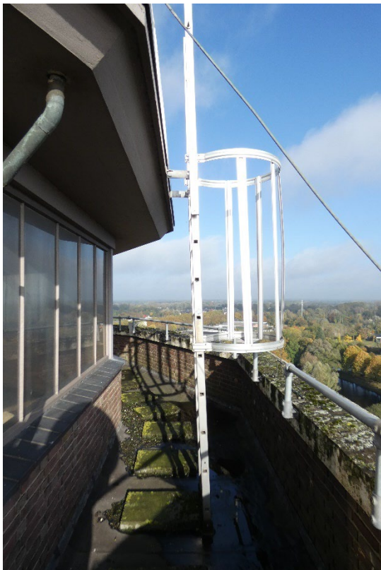
Afb. 29. De aluminium kooiladder voor het betreden van het dak.
