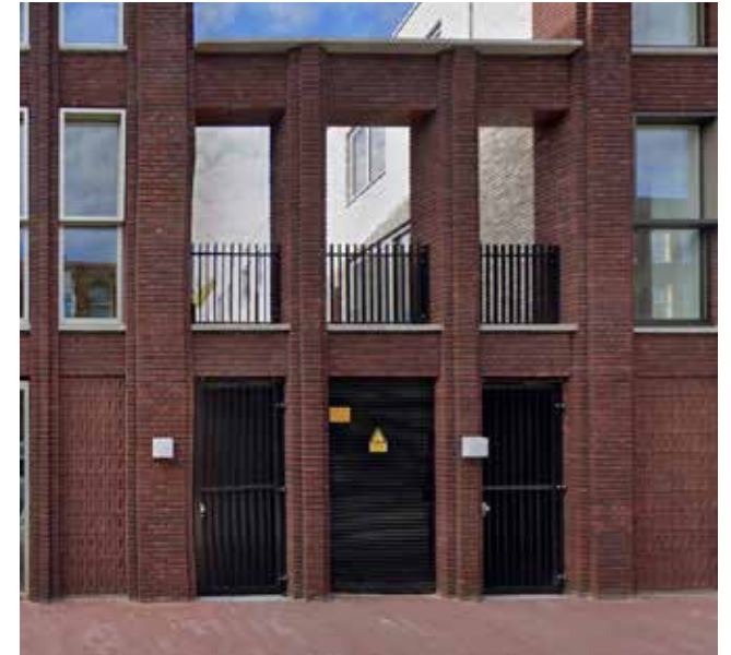
Technische installaties geïntegreerd in het gevelontwerp
