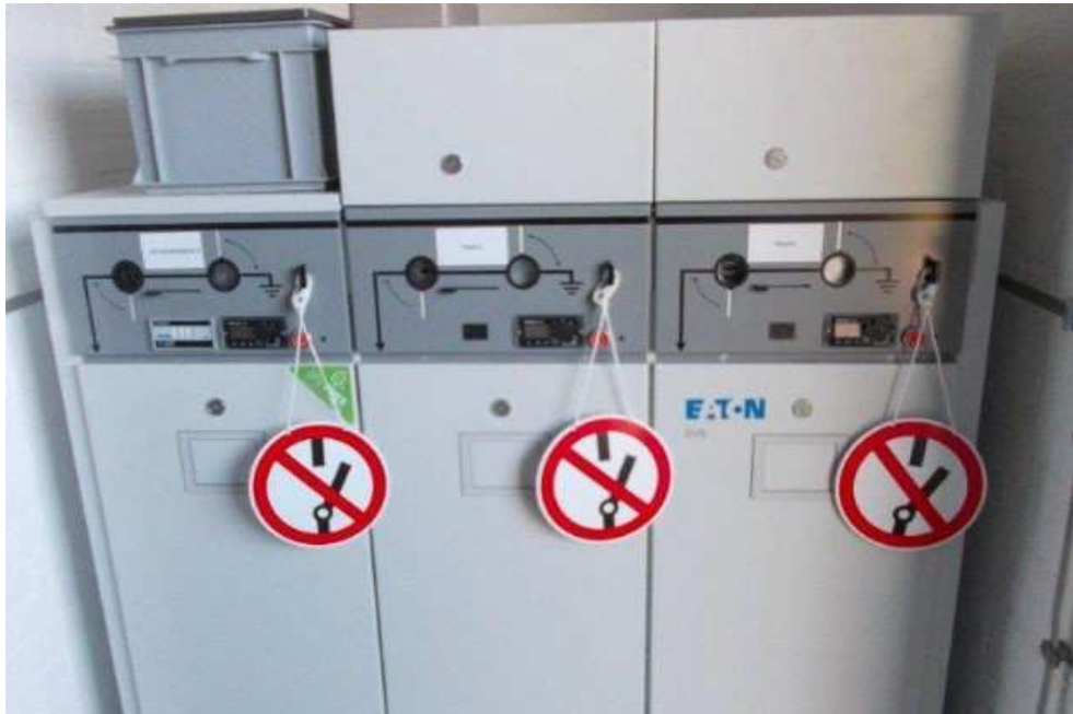
Fig. 8.1 Hoogspanning schakelinstallatie gemaal Vier Noorder Koggen Holec SVS-6.
