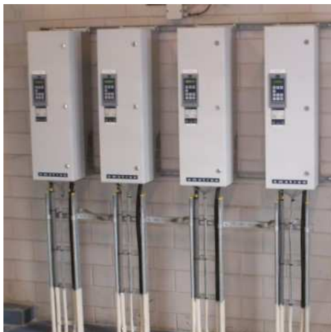
Fig. 19-5 : Frequentieomvormers in rioolgemaal Schagen (2011).
