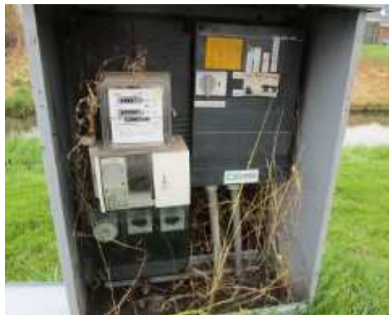
Fig. 15.1: "Bezit geeft zorg!", na inspectie aangetroffen onkruid in schakelkast.
