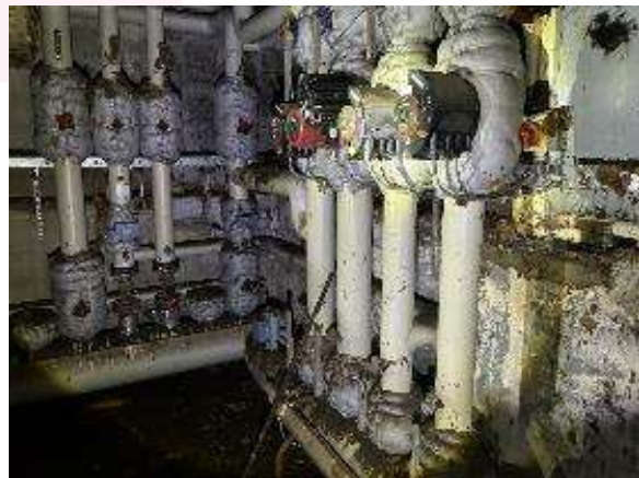
Hydraulische installaties van het centrale verwarmingssysteem
