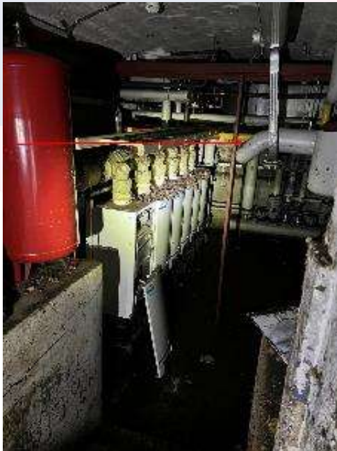
Technische ruimte met daarbij de waterlijn
