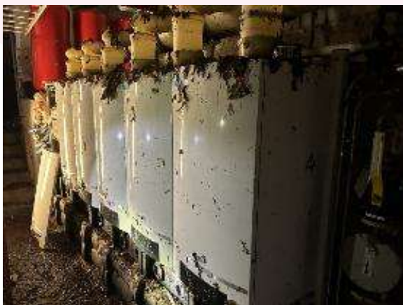
Cv ketels van centrale verwarmingssysteem
