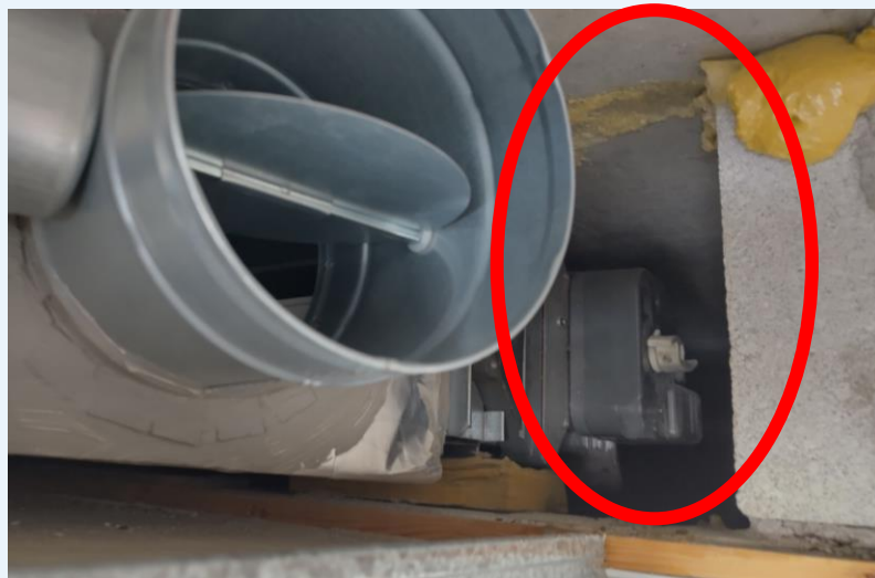
figuur 8: Een brandklep (grijs) in de toevoerventilatie zonder brandwerende afwerking om de klep.
