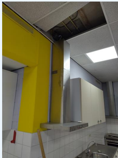
figuur 7: Afzuigkappen die niet zijn aangesloten zijn op afvoerventilatie.
