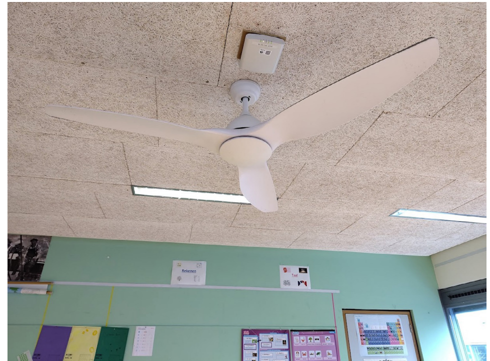
Plafondventilator zorgt voor energiezuinige koeling in een school
