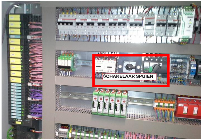
Afbeelding 13.15: Schakelaar 'Spuien' op montageplaat in besturingskast (omcirkeld met rood)
