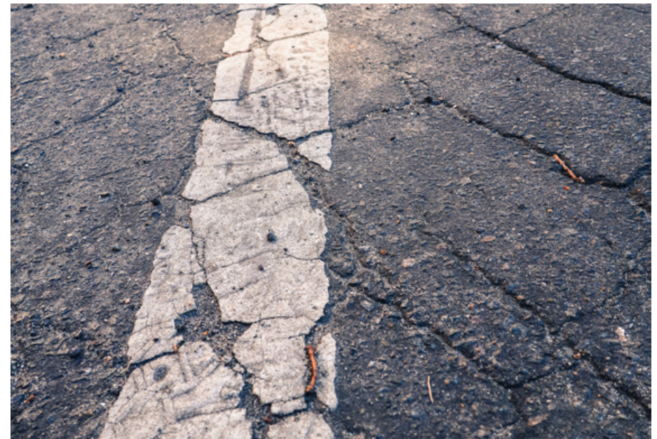
▲ Droogte kan zorgen voor schade aan wegen.
