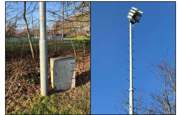
Bestaande lichtmast met armatuur, Cilindrisch verjongd
