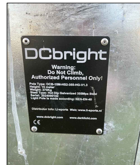
Bestaande lichtmast, Octoconaal
