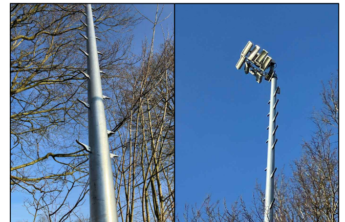
Bestaande lichtmast met armatuur Cilindrisch conisch
