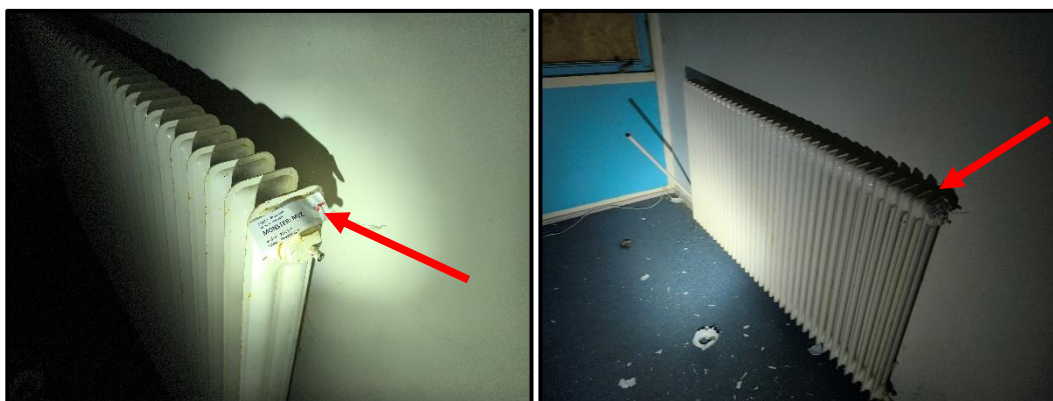
Bron 2/M12: asbesthoudende pakking in radiator.
