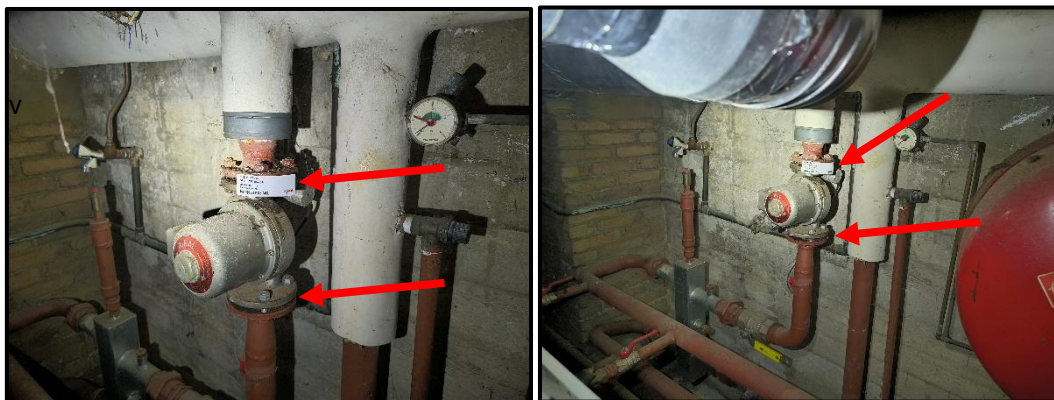
Bron 1/M1: asbesthoudende pakkingen tussen flenzen cv-leidingen.
