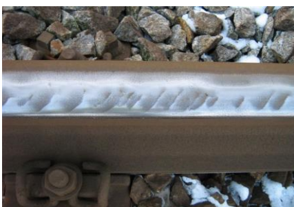
Oppervlakte defect (headchecks)
