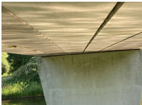
2 Schade: Wapeningscorrosie bovenzijde steunpunt. Stp 02+03 Oorzaak: Wapeningscorrosie mogelijk als gevolg van chloride indringing vanaf de bovenzijde/achterzijde. Risico: Verminderde duurzaamheid. Maatregel: Betonreparatie volgens CUR 118.
