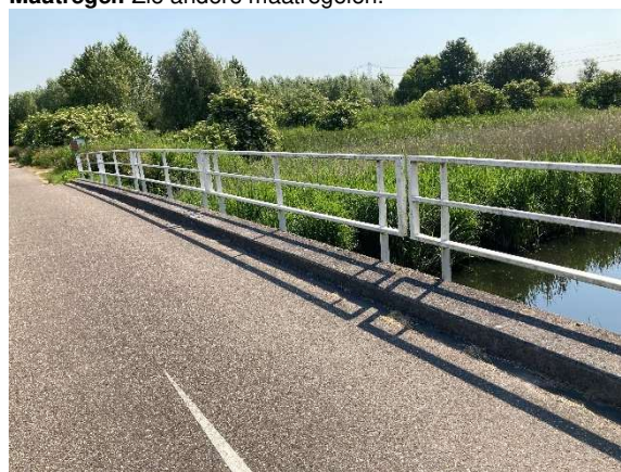
4 Schade: Vervuild door aangroei. Oorzaak: Klimatologische invloed/onvoldoende reinigen. Risico: Verminderde toonbaarheid Maatregel: Reinigen.
