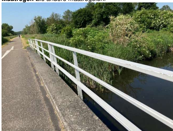
3 Schade: Leuninghoogte voldoet niet in de toekomstige situatie. Oorzaak: Wet- en regelgeving (CE-keurmerk) Risico: Verhoogde aansprakelijkheid bij ongevallen. Maatregel: Vervangen leuningwerk.
