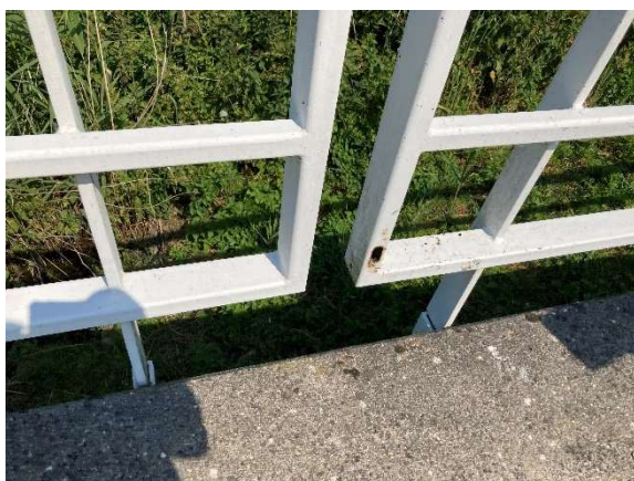
1 Schade: Corrosie aan stalen leuningwerk. Oorzaak: Klimatologische invloeden geïnduceerd door lokale beschadiging van de conservering. Risico: Verminderde duurzaamheid Maatregel: Zie andere maatregelen.
