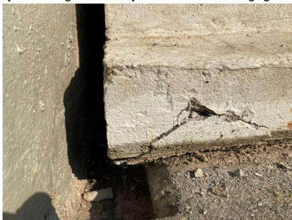
1 Schade: Betonschade rand liggerflens stp01+4 zb01 Oorzaak: Wapeningscorrosie. Risico: Verminderde duurzaamheid. Maatregel: Betonreparatie volgens CUR118.
