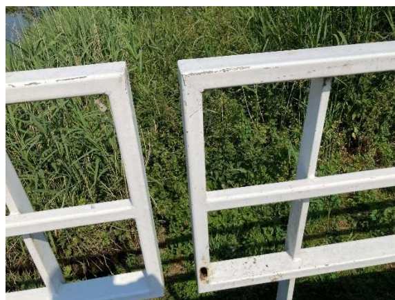
2 Schade: Conservering is verouderd en is regelmatig onthecht. Oorzaak: Einde levensduur Risico: Verminderde duurzaamheid Maatregel: Zie andere maatregelen.
