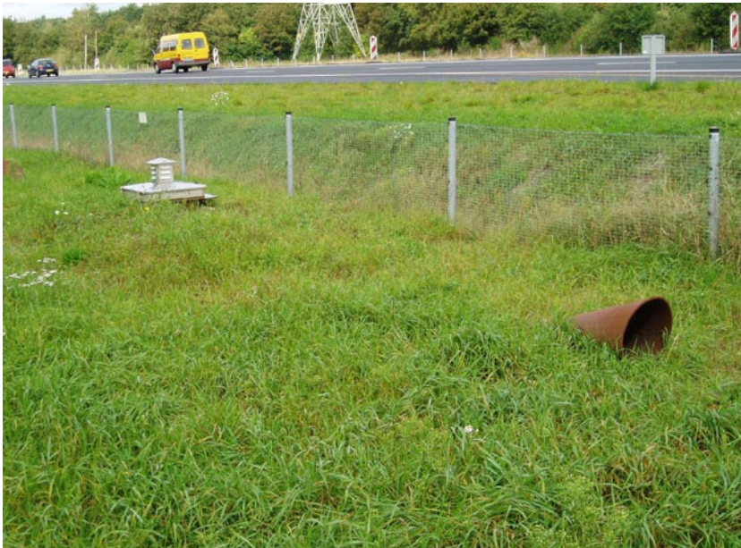
Doordat geleiding naar de buisingang ontbreekt, zal de buis niet optimaal functioneren
