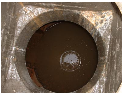
Inspectieput vol met water
