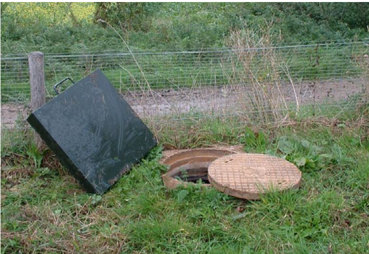
Inspectieput met goed afsluitbare deksel, putdeksel type zwaarverkeer is niet waterdicht; waterdicht maken met stalen deksel die past om gehele gietijzeren putgedeelte
