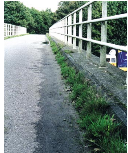
Gebrek aan onderhoud kan onbedoeld een faunapassage voor kleine dieren laten ontstaan
