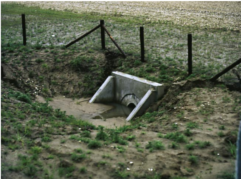
Tunnel met water kan niet functioneren
