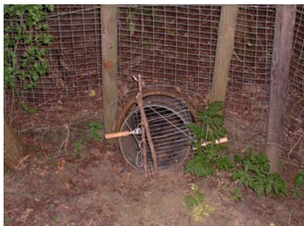
Inspectie van faunavoorzieningen: tunnel is dichtgezet door onbevoegden
