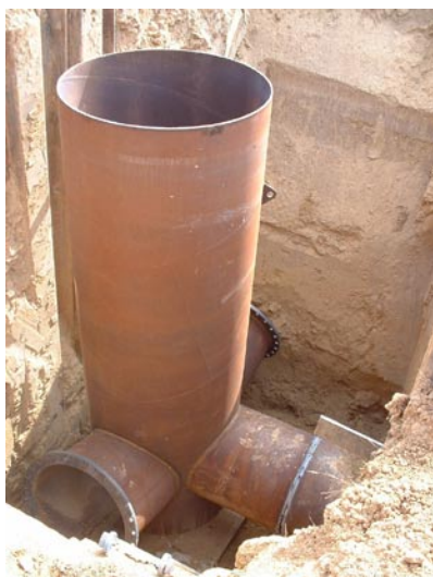
Compleet stalen voorziening (tunnel onder de weg, in- en uitloopvoorziening en inspectieput, Rijksweg 79)
