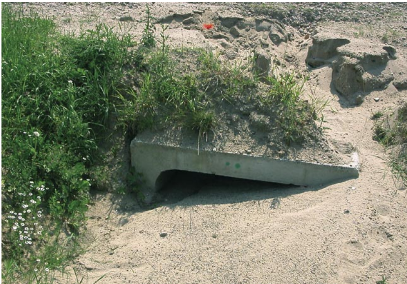
Tunnel kan niet functioneren door verstopping met grond
