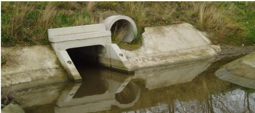
Deze faunabuis komt vrijwel direct uit op het vrij steile betonnen talud van een watergang en zal daardoor niet optimaal functioneren
