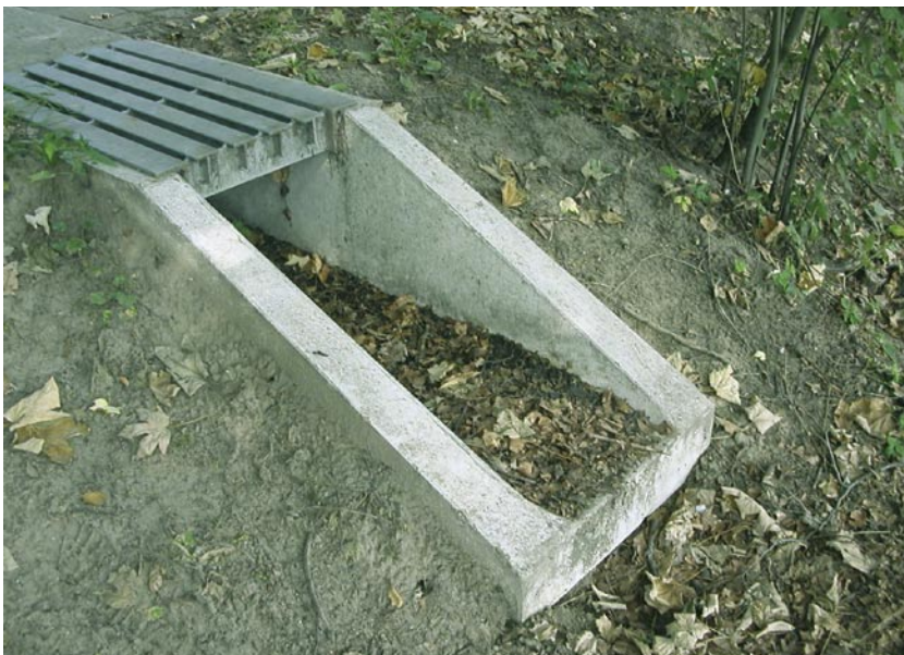
Door onjuiste aanleg of wegspoelen grond na de aanleg is de tunnelingang niet bereikbaar voor amfibieën
