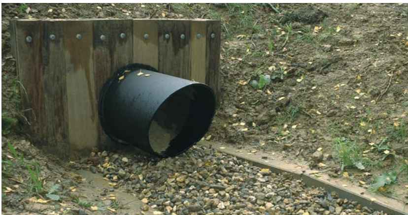
Kleine faunatunnel met grindkoffer en 'overkapping'; het raster is later geplaatst
