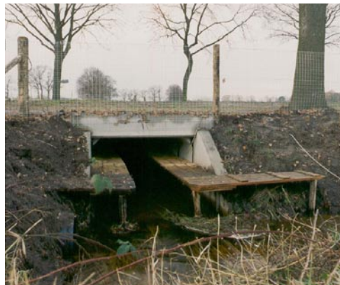
Aangepaste duiker; loopplanken sluiten goed aan op de oevers
