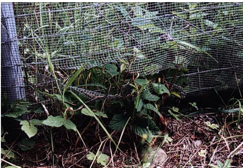
Vermoedelijk door maaimachine beschadigd raster
