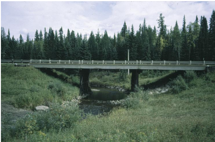
Als een weg een waterloop kruist, kunnen de oevers onder de brug functioneren als faunapassage
