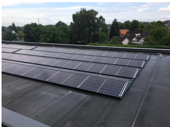
3. Zonnepanelen allen in oostwest-opstelling
