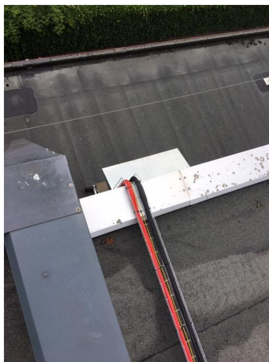
2. Omvormer op het dak, kabels gescheiden in de goot
