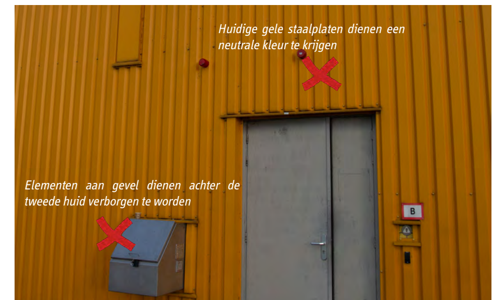
Figuur 26. In de huidige situatie zijn er verschillende elementen aan de gele gevel bevestigd.
