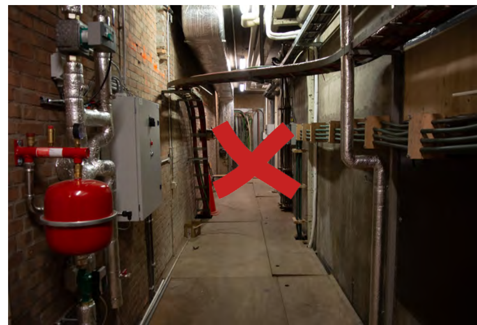
Figuur 37. Oude niet in gebruik zijnde kabels, leidingen en installaties dienen verwijderd te worden.
