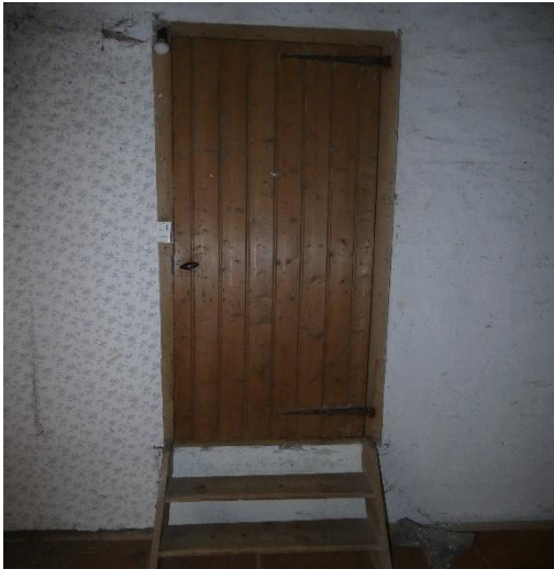
6.4.37. Een van de buitenste zolders van het voorhuis. In de dwarswand bevindt zich een deurenkozijn met een originele opgeklampte deur voorzien van gesmede staartgehengens uit de bouwtijd van de boerderij.
