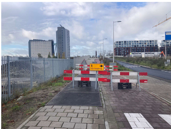
Figuur 4 geplaatste afzetting die niet voldoet aan de gestelde eisen op Plusnet Fiets langs de Amstelstroomlaan
