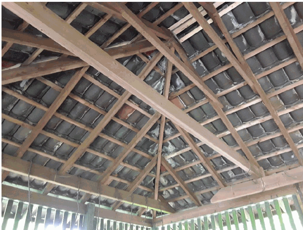
40B18E3, geen dakbeschot aanwezig
