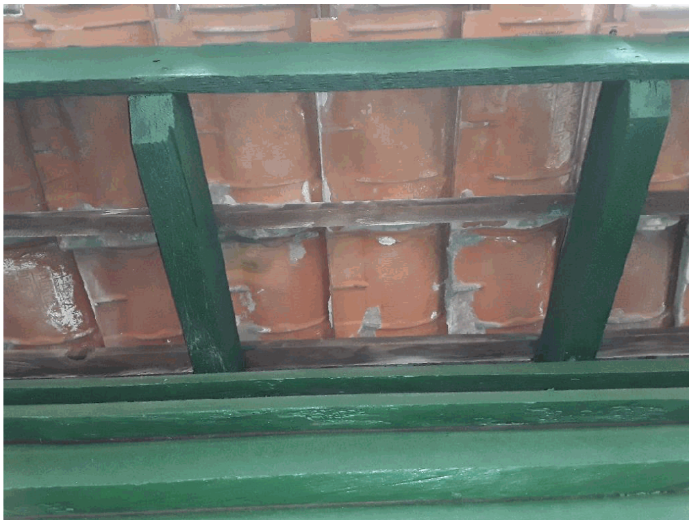
40B18E1, geen dakbeschot aanwezig
