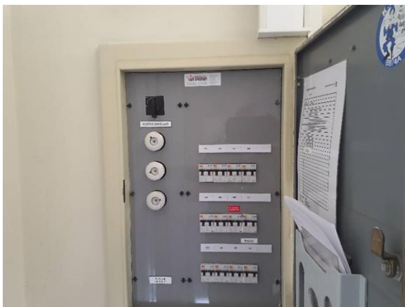
FB09: De LS-schakelaar kan asbesthoudend zijn. Omdat de installatie onder spanning staat, kan dit niet worden gecontroleerd.
