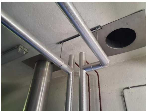
FB06: De 1e verdieping / dakconstructie is onbereikbaar voor inspectie.
