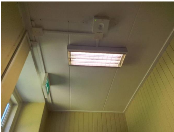
FB05: Boven vaste plafonds is geen inspectie mogelijk.
