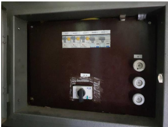
FB05: De LS-schakelaar kan asbesthoudend zijn. Omdat de installatie onder spanning staat, kan dit niet worden gecontroleerd.
