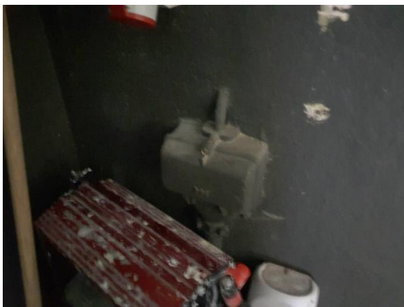
FB06: Het koord in het stalen elektrakastje is conform de oude rapportage niet asbesthoudend.
