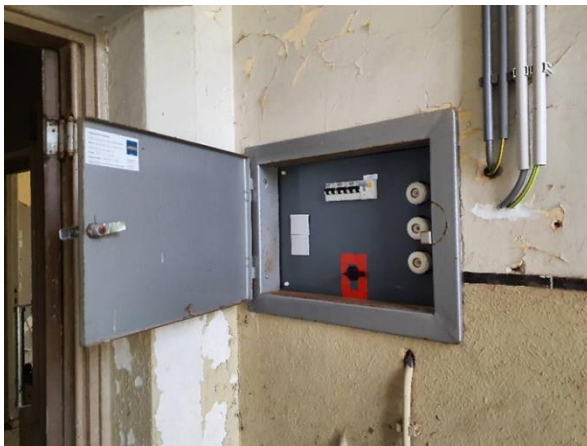
FB05: De LS-schakelaar in ruimte 7 staat mogelijk onder spanning en deze is om veiligheidsredenen niet onderzocht.
