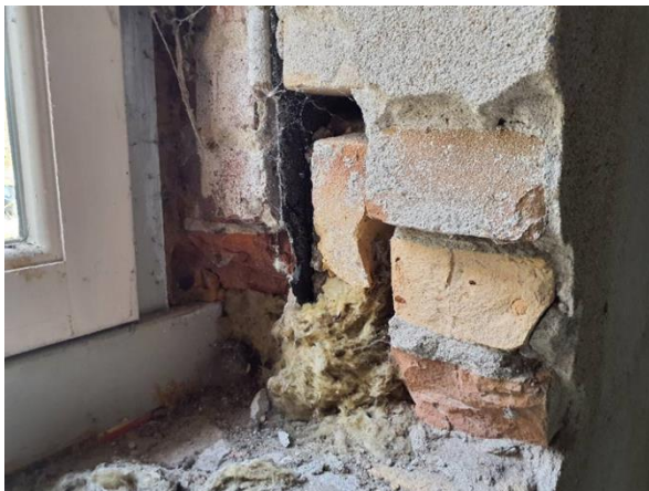
FB02: De bitumen slabben (vochtkering) in de gevel is conform de oude rapportage niet asbesthoudend.
