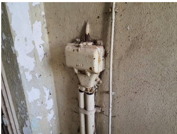
FB03: Het koord in het elektrakastje is conform de oude rapportage niet asbesthoudend.
