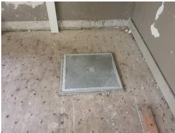
FB06: De kruipruimte is in verband met de aangetroffen asbesthoudende restanten vloerafwerking (B01) niet verder onderzocht.
