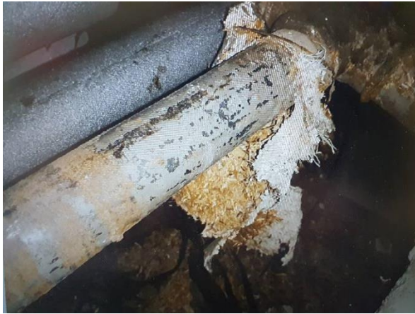
FB04: De leidingisolatie in de kruipruimte is conform de oude rapportage niet asbesthoudend.
