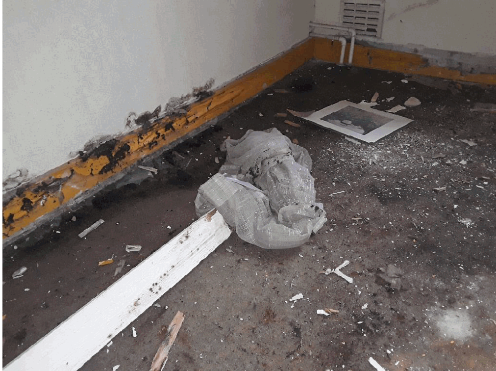
40B1859, ruimte 1.12 hier is een deel van de vloer in slechte staat en deels verzakt. Hier bij sanering van bron 1018-59-001 in deze ruimte terdege rekening houden!
