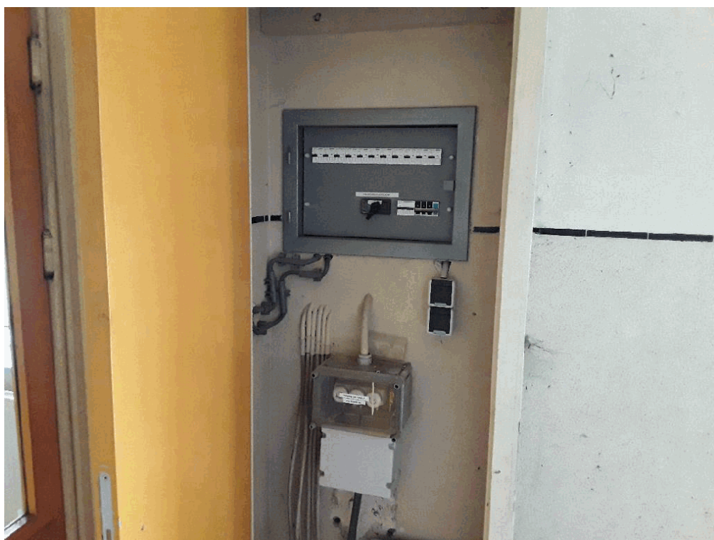
40B1859, ruimte 1.01A elektrische installatie niet asbestverdacht
