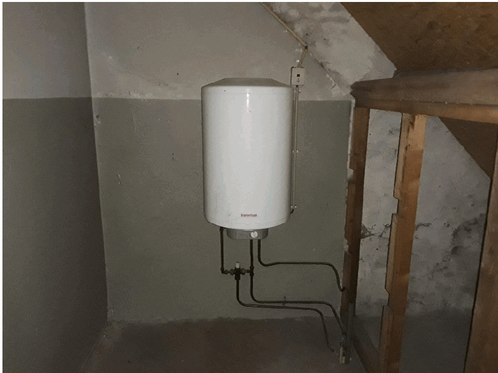
40B1859, ruimte1.15 boiler merk Inventum niet asbestverdacht
