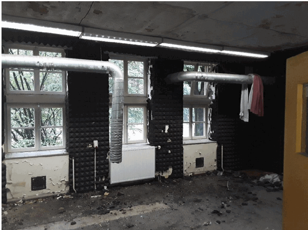
40B1859, ruimte 1.04 veel wand- en plafondaftimmeringen aanwezig (kleefmonsters genomen i.v.m. bron 1018-59-001)
