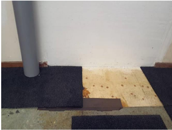
FB04: De asbesthoudende vloerafwerking ter plaatse van de voormalige kluis in ruimte 1.02 is niet meer aangetroffen.
