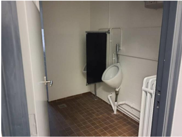
FB07: Achter het tegelwerk is geen inspectie mogelijk.
