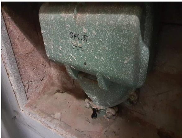
FB09: Het koord in het elektrakastje is conform de oude rapportage niet asbesthoudend.
