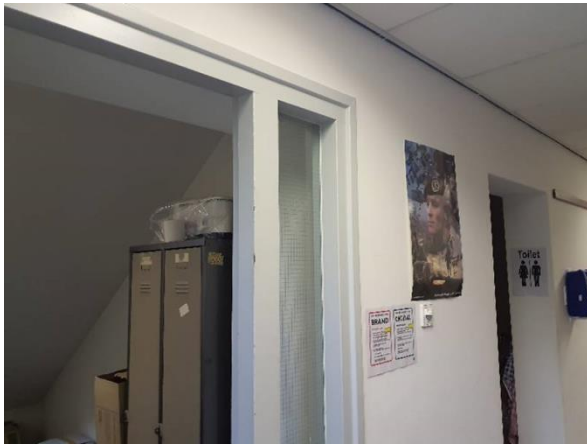
FB08: Ter plaatse van de binnenkozijnen met enkel glas kan asbestverdachte kit aanwezig zijn. Dit kan alleen met destructief onderzoek worden bepaald.
