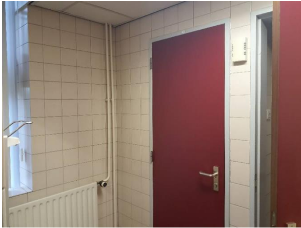
FB01: Achter het tegelwerk is geen inspectie mogelijk.
