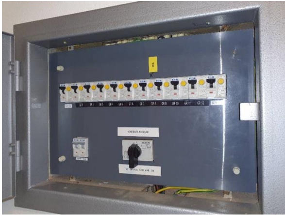
FB07: De LS- schakelaar is niet asbestverdacht.
