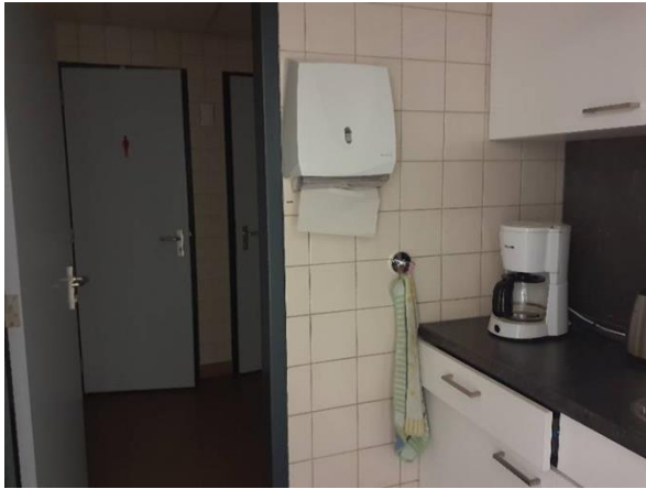
FB10: Achter het tegelwerk is geen inspectie mogelijk.
