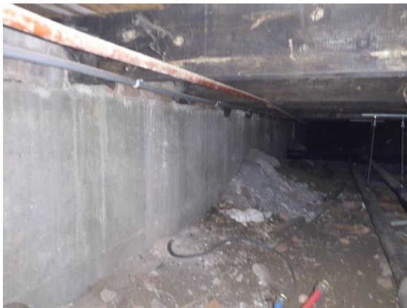
FB08: De bitumen stroken tussen metselwerk en vloerbalken in de kruipruimte zijn conform de oude rapportage niet asbesthoudend.
