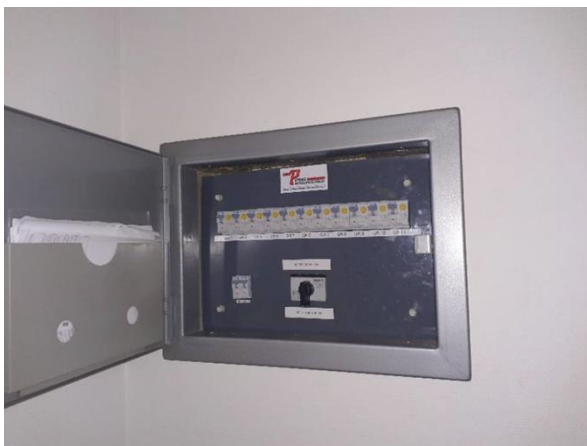
FB09: De LS-schakelaar is conform de oude rapportage niet asbestverdacht.
