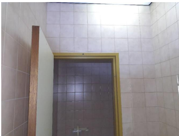
FB12: Achter het tegelwerk is geen inspectie mogelijk.
