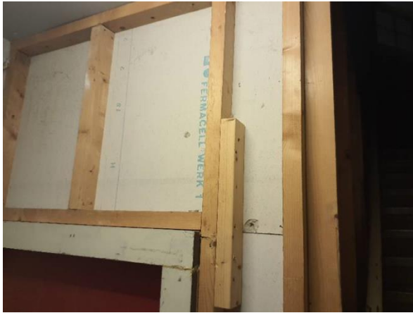
FB04: De brandvertragende fermacell wandbeplating is niet asbestverdacht.
