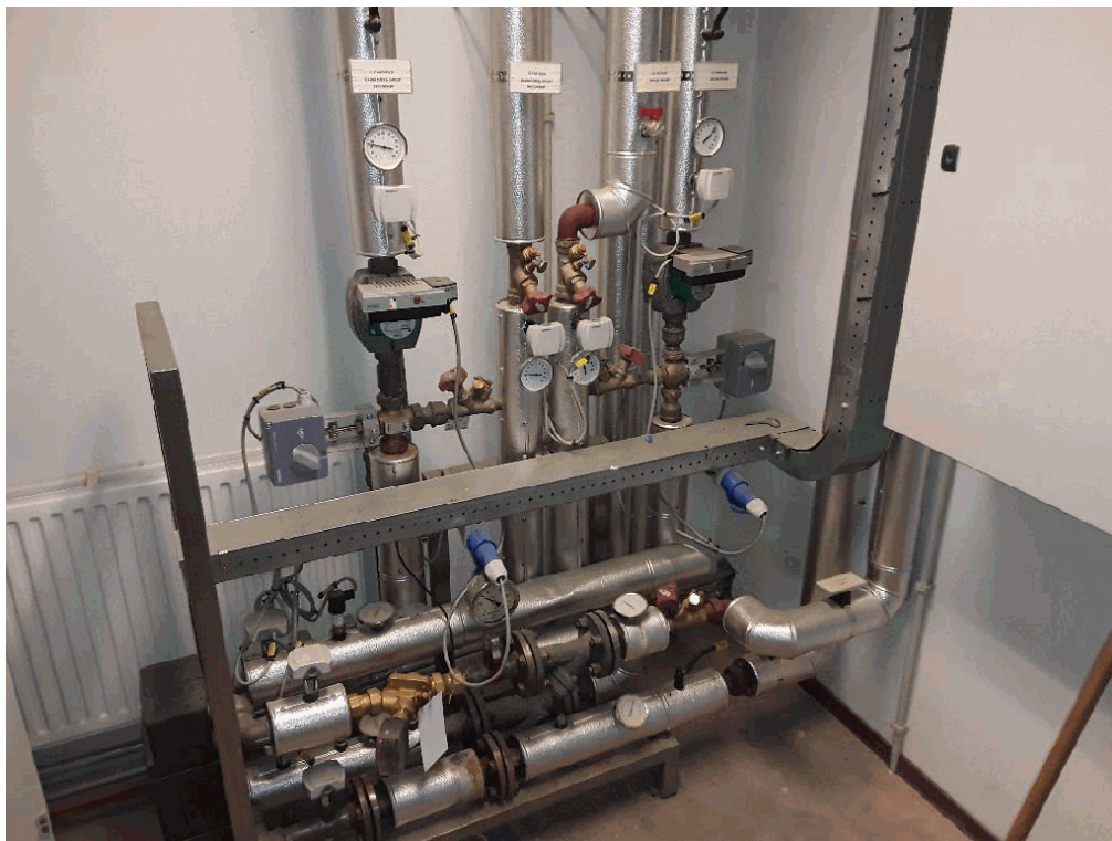
40B1825, ruimte 1.03 cv-installatie Kuijpers, zie bron 1018-25-004
