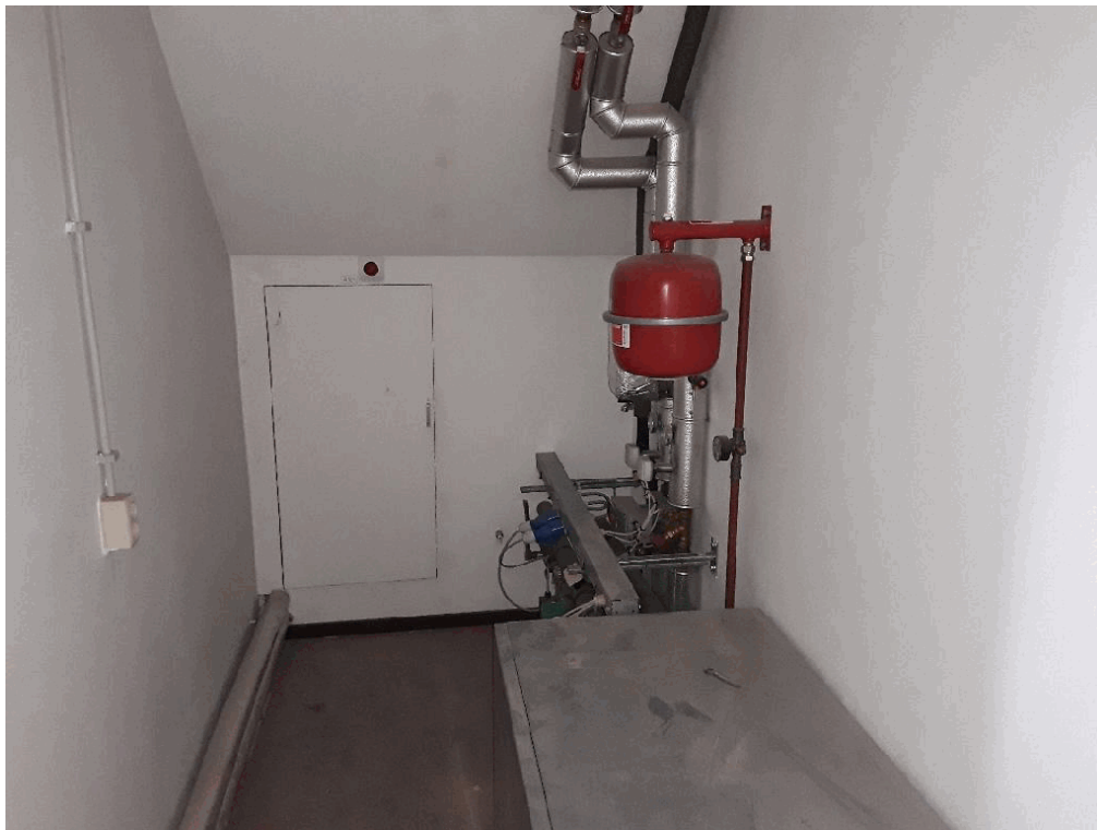
40B1825, ruimte 1.04 warmwater installatie Kuijpers niet asbestverdacht
