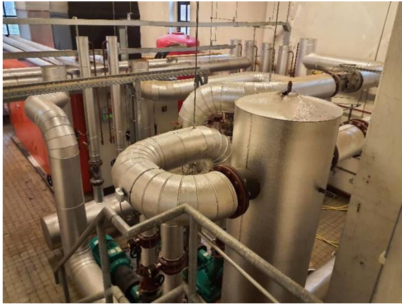
FB13: De c.v.- installatie en bijbehorend leidingwerk is geplaatst in 2011 en is derhalve niet asbestverdacht.
