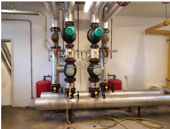
FB12: De c.v.- installatie en bijbehorend leidingwerk is geplaatst in 2011 en is derhalve niet asbestverdacht.
