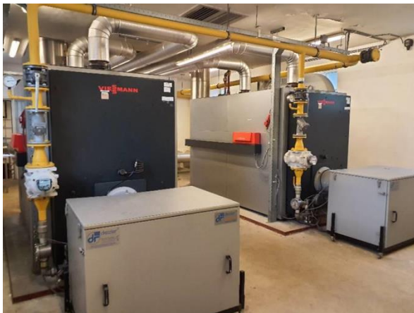
FB11: De c.v.- installatie en bijbehorend leidingwerk is geplaatst in 2011 en is derhalve niet asbestverdacht.
