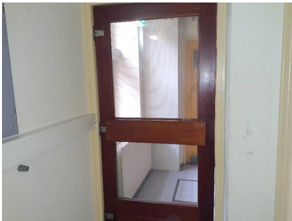
FB05: Ter plaatse van de binnendeuren met enkel glas kan asbestverdachte kit aanwezig zijn. Dit kan alleen met destructief onderzoek worden bepaald.
