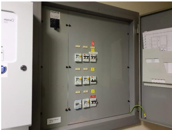
FB11: De LS- schakelaar is niet asbestverdacht.
