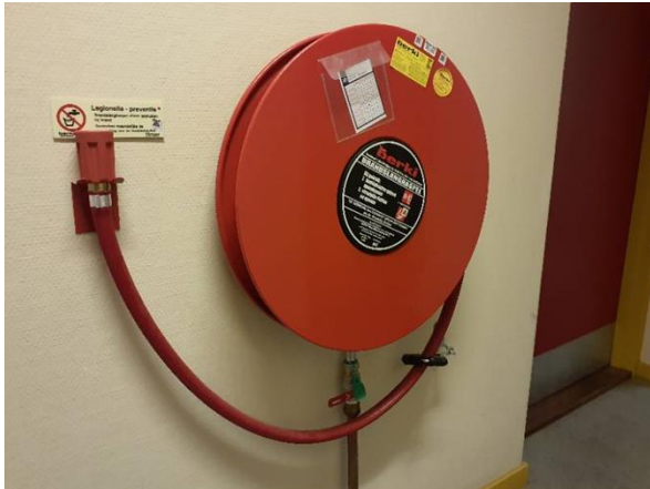
FB10: De brandslanghaspel met asbesthoudende pakking, welke in de oude rapportage werd benoemd, is niet meer aanwezig.
